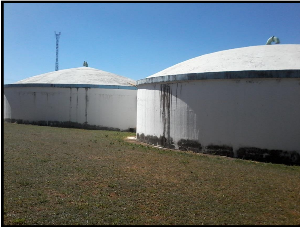
Figura 17 – Reservatórios “Jardim Europa”
