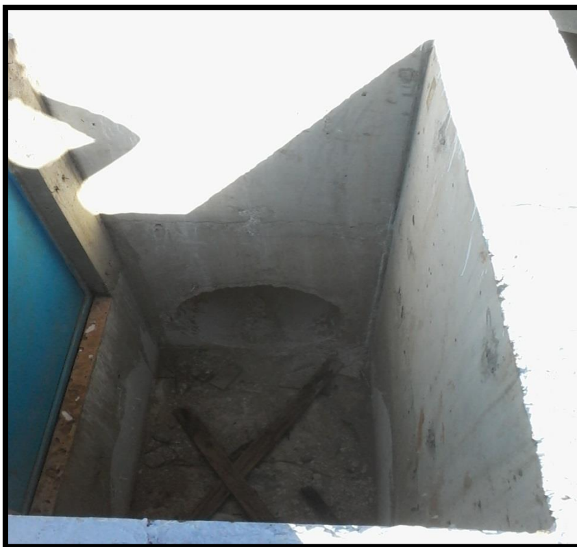
Figura 23 – Caixa de passagem
