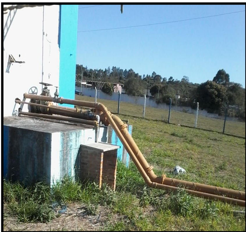
Figura 10 – Poço do Distrito Industrial
