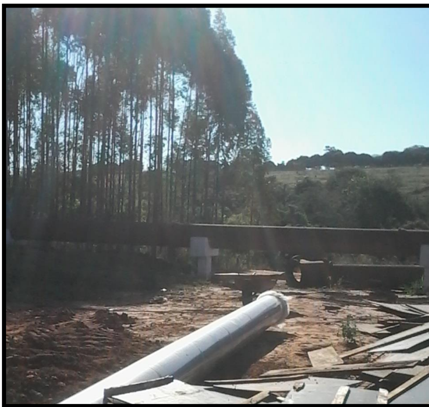
Figura 22 – Tubulação de entrada do esgoto na ETE
