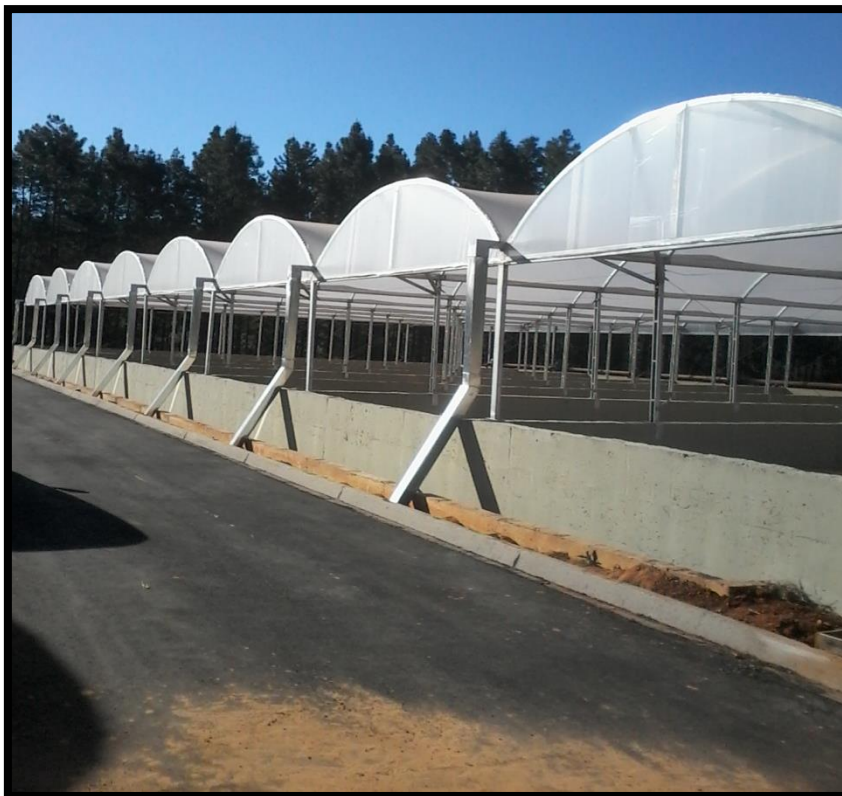
Figura 30 – Leitos de secagem de lodo
