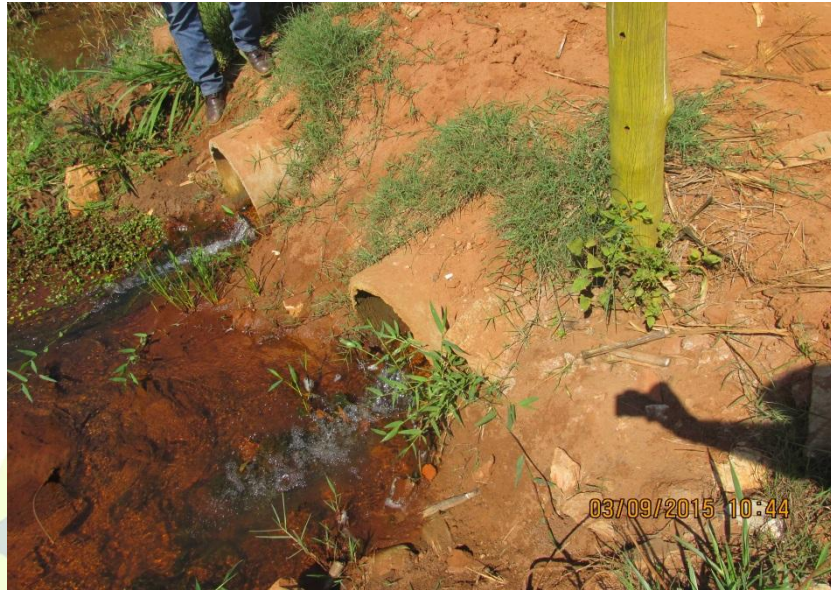
Figura 37 – Duas tubulações de 400mm de concreto, app não vegetada.
