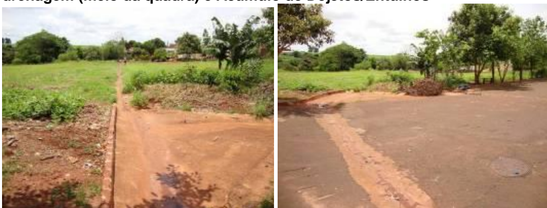
Foto 7 e 8 – Final da Rua João Príncipe - Passagem inadequada do sistema de drenagem (meio da quadra) e Acumulo de Dejetos/Entulhos
