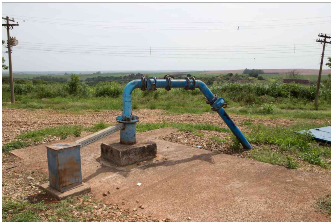
Fotografia 28 - Poço de água bruta P 08.
