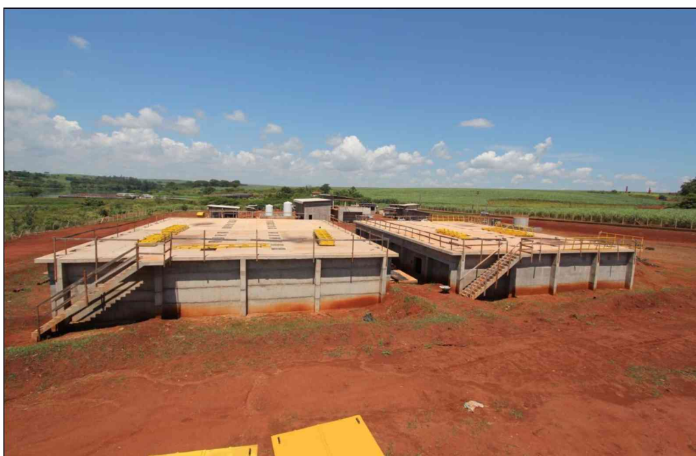
Fotografia 47 - Reatores UASB – ETE Sonho Nosso.
