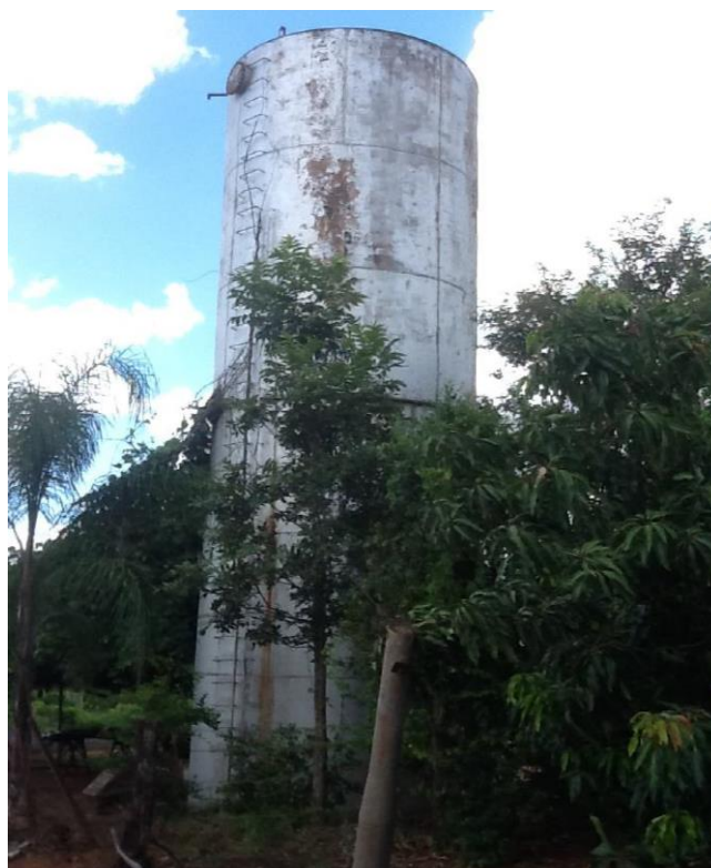
Foto 6.31 – Reservatório Distrito Cupurá
