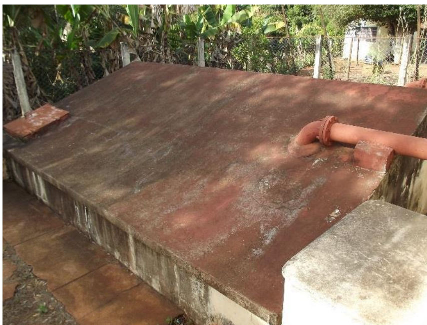
Foto 6.7 – Caixa de Recalque
