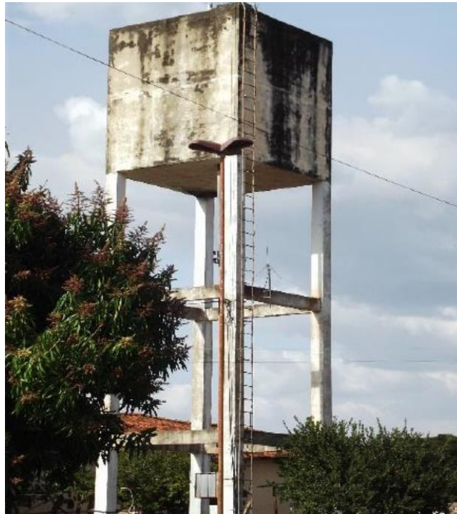
Foto 6.13 – Reservatório Jd. Bela Vista IV
