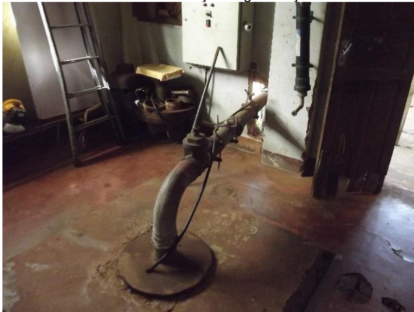
Foto 6.24 – Poço Vila Rossi
