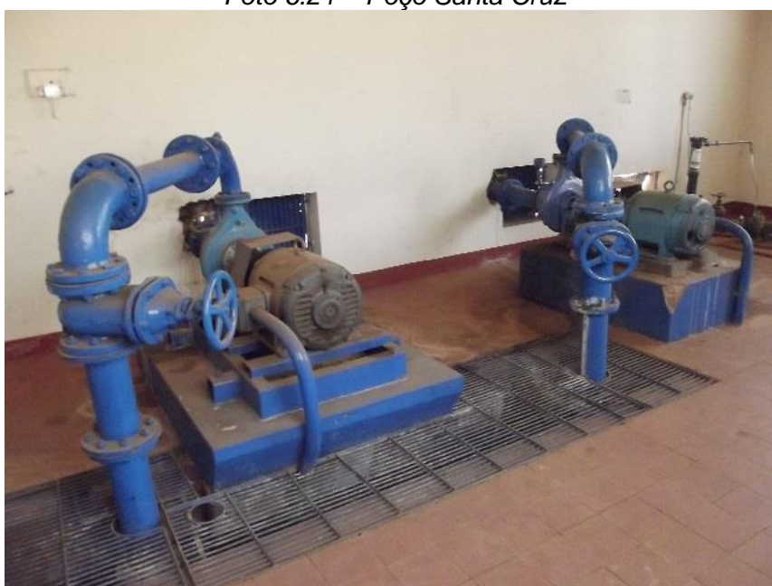
Foto 6.22 – Sistema de Bombeamento da Antiga Estação
