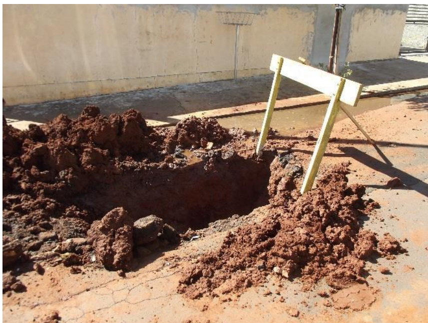
Foto 6.32. – Ponto de Manutenção da Rede de Distribuição.
