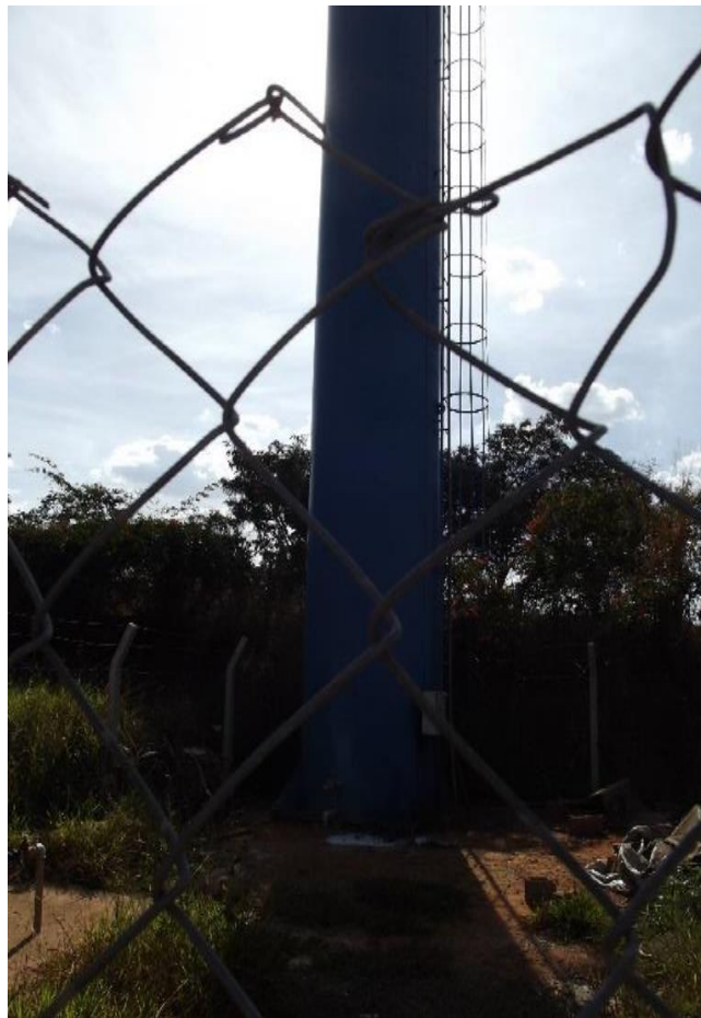
Foto 6.6 – Reservatório Av. Saudades
