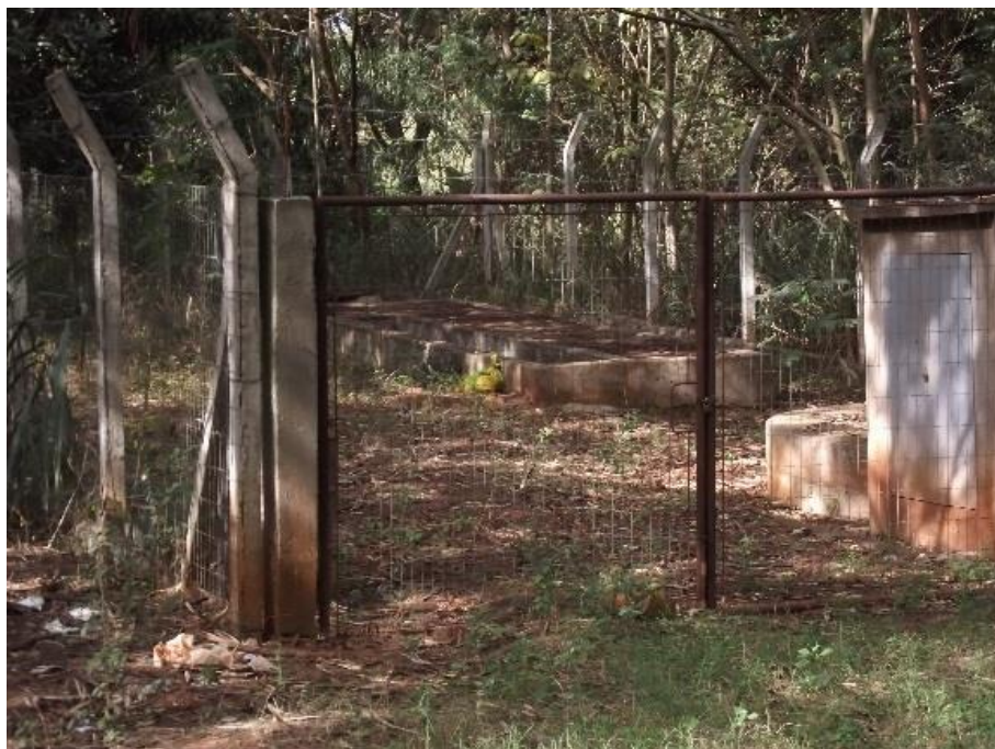
Foto 6.33 – Estação Elevatória Vila Santa Cruz
