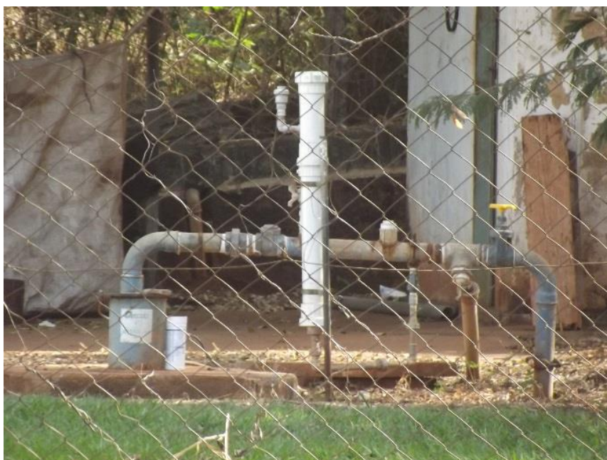
Foto 6.21 – Poço Santa Cruz
