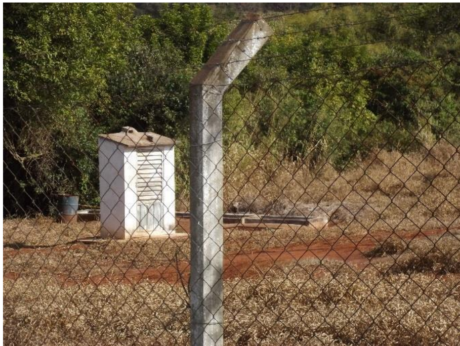
Foto 6.34 – Estação Elevatória da Estação de Tratamento
