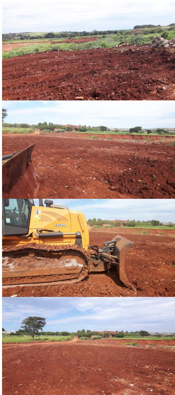
Figura 26.4 – Fotografias do bolsão de entulho. Fonte: Prefeitura Municipal.
