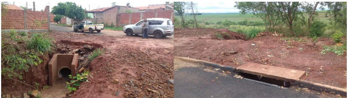
Figura 25.6 – Rua Mário Schidvon próxima ao córrego da Cachoeirinha – área com erosão Fonte: Líder Engenharia
