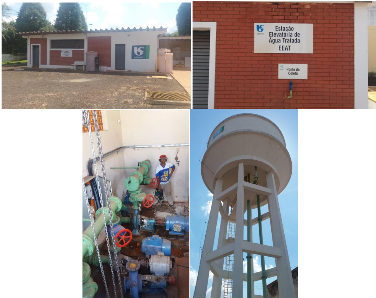
Figura 23.8 – Estações Elevatórias de Água Tratada Fonte: Líder Engenharia
