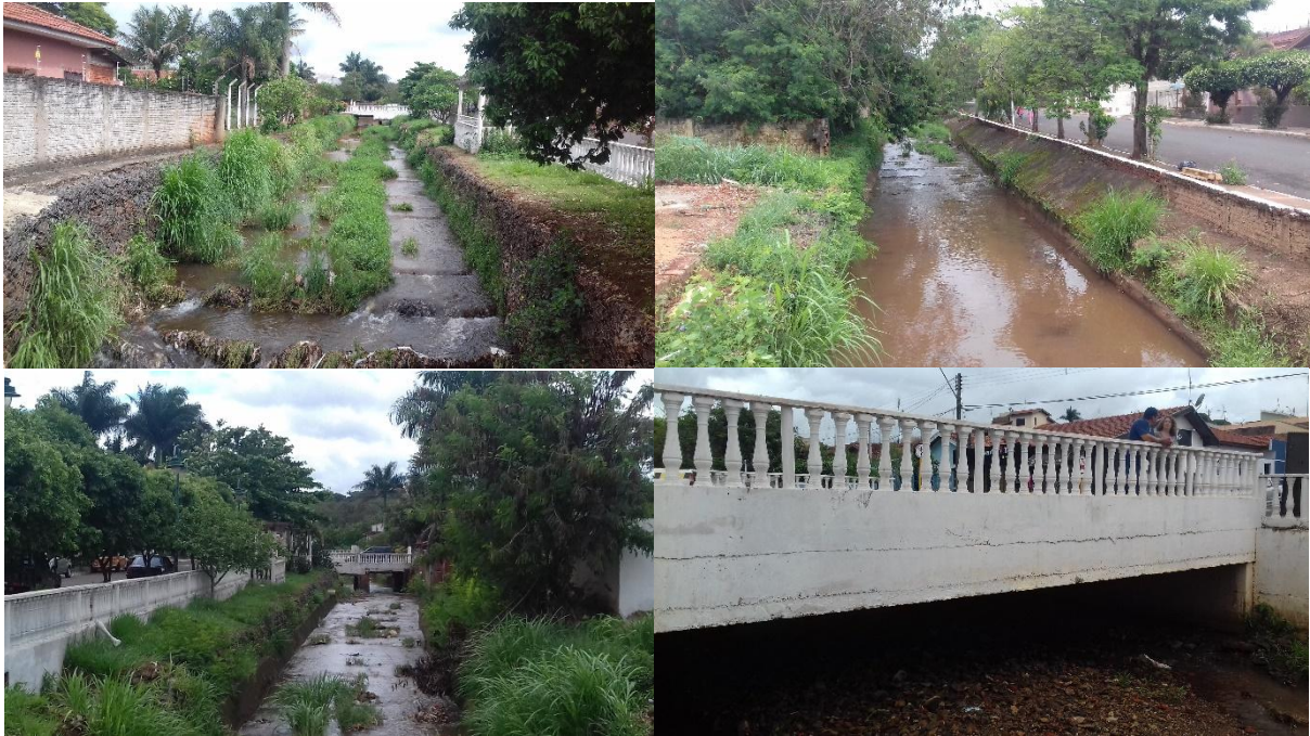
Figura 25.12 – Córrego Água do Monojolo próximo à Rua Cap. Joaquim Barreto – travessia subdimensionada.
