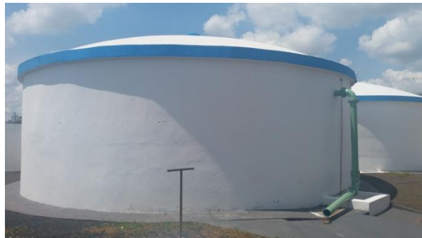
Figura 23.9 - Reservatório – água provinda do P12.
