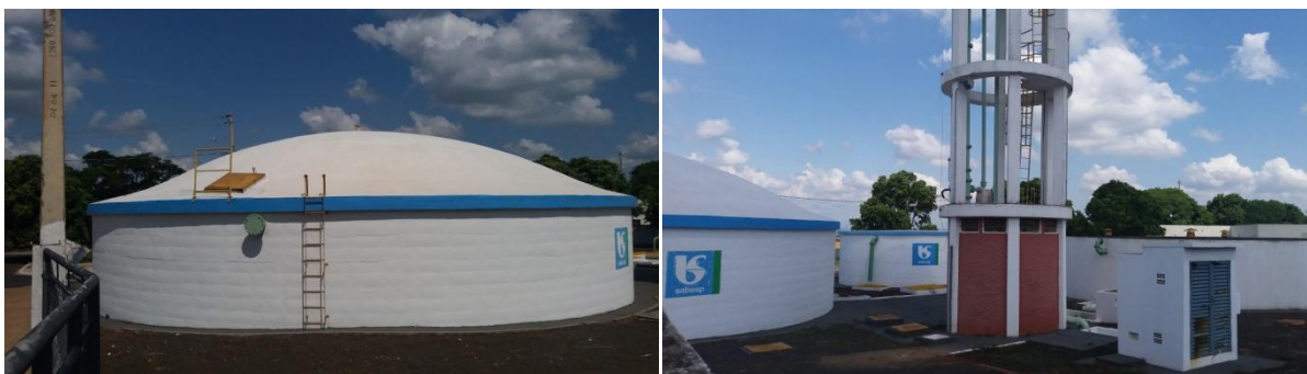
Figura 23.11 - Reservatório – água provinda do P13.
