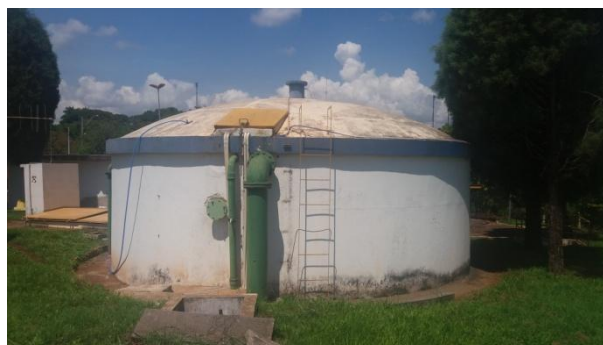
Figura 23.10 - Reservatório – água provinda do P13.
