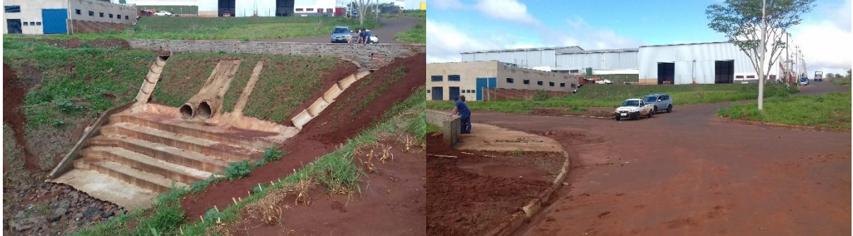
Figura 25.9 – Local próximo ao lago da Av Dr. Anthero F.Nunes – local com erosão.
