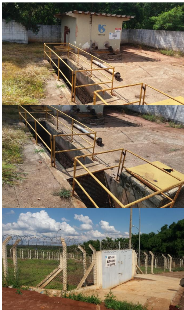
Figura 24.1 – Estações Elevatórias – novembro de 2016
