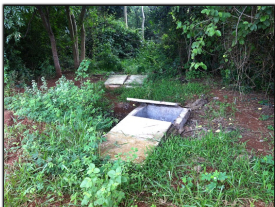
Figura 70. Saída da ETE
