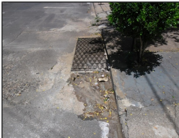
Figura 96. Galeria 1 - Boca de lobo com boca grelha apresentando deficiência na limpeza
