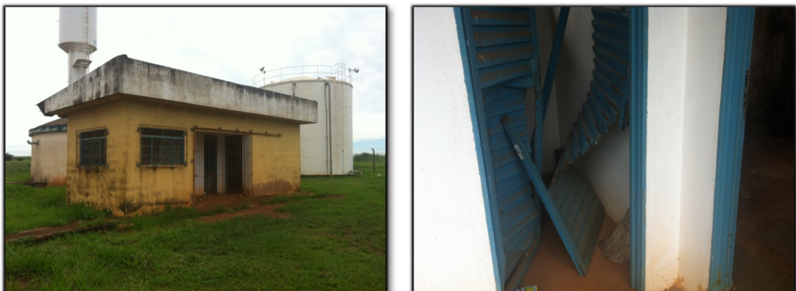
Figura 48. Casa de máquinas
