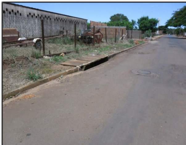
Figura 130. Galeria 7 – Boca de lobo dupla de guia
