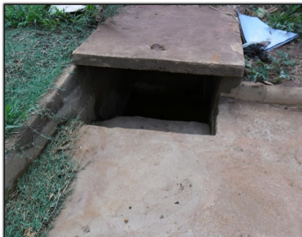
Figura 156. Bloco III – Galeria 9 – boca de lobo simples de guia lateral – abertura excessiva
