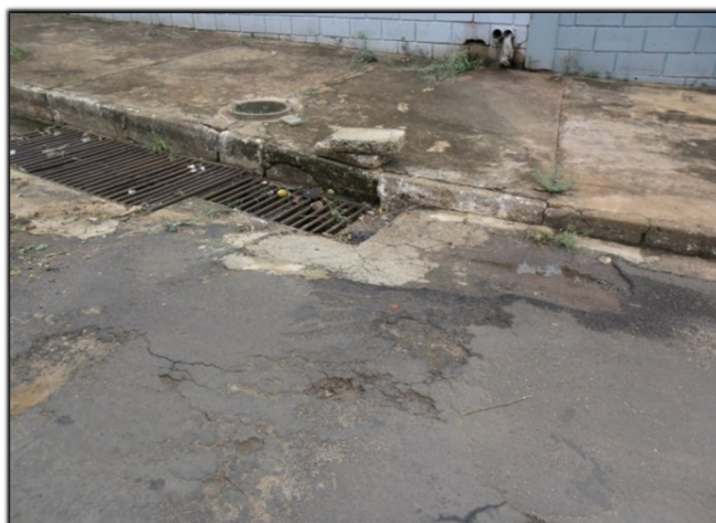
Figura 107. Galeria 3 - Boca de lobo dupla com boca grelha.
