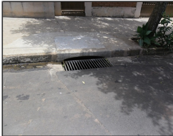
Figura 139. Galeria 8 – Ramal Aureliano - boca de lobo simples de grelha
