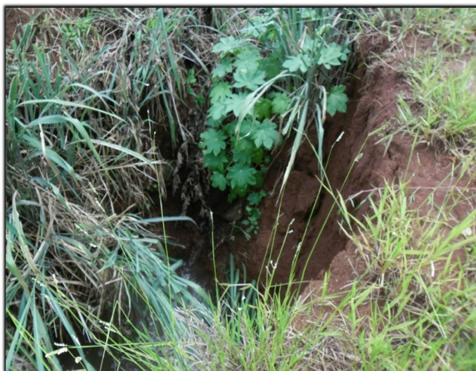
Figura 112. Galeria 4 - Ponto de lançamento – PL 5 / STP – processo erosivo
