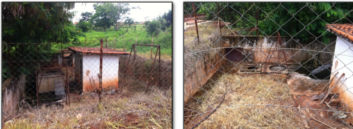
Figura 60. Estação elevatória de esgotos
