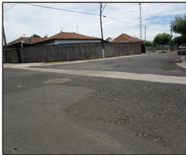
Figura 144. Galeria 8 – Ramal 12 de Janeiro – condução da água por sarjetões
