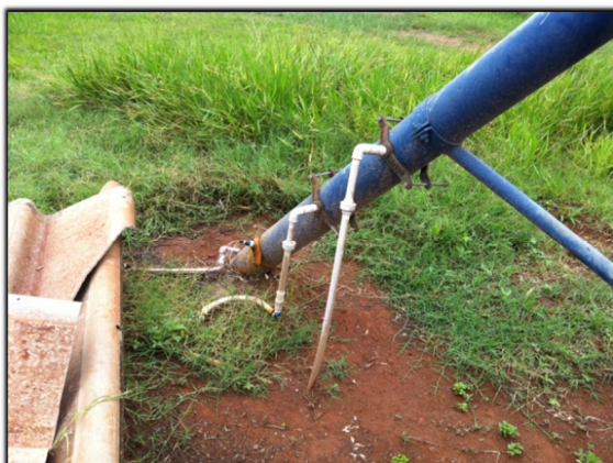
Figura 41. Sistema de dosagem no 13 de Maio
