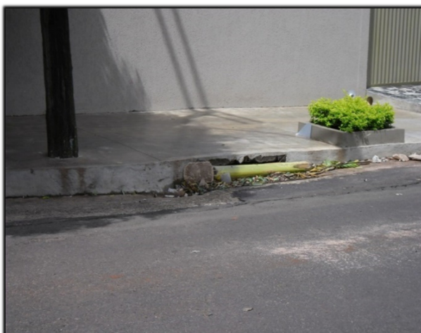
Figura 147. Galeria 8 – Ramal 12 de Janeiro – boca de lobo simples de guia obstruída
