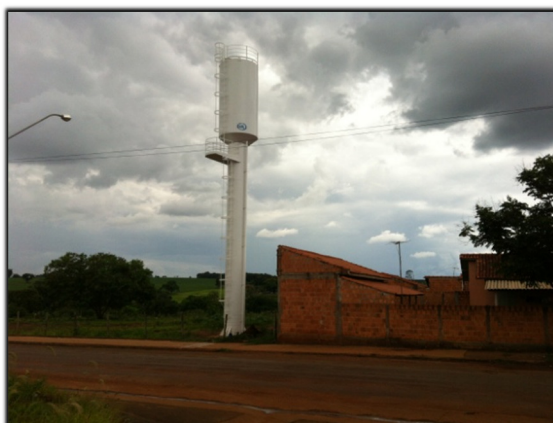
Figura 37. Reservatório elevado metálico (25 m 3 ) - CDHU
