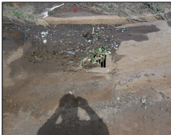
Figura 155. Galeria 9 – boca de lobo simples de grelha – acumulo de resíduos
