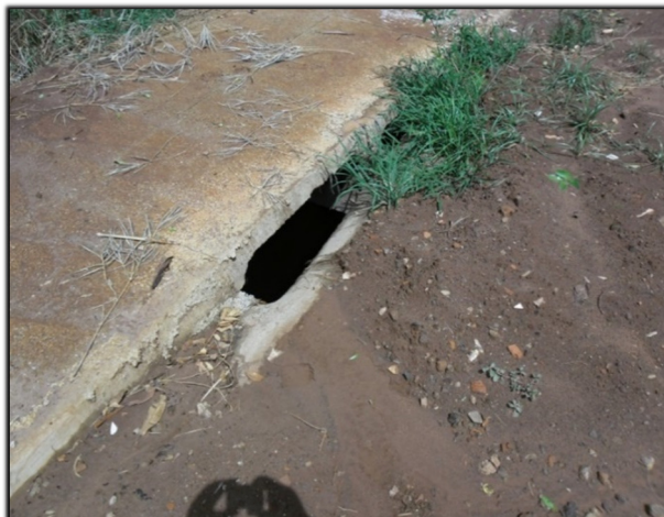
Figura 132. Galeria 7 – Boca de lobo dupla de guia
