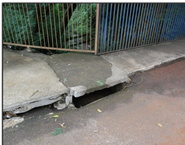
Figura 123. Captação da Rua Júlio Cardilli – na cabeceira da ponte sobre o Córrego Nova Europa
