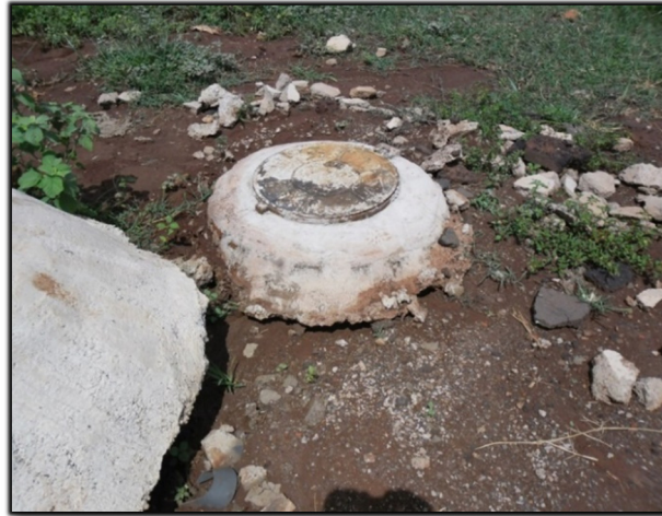
Figura 149. Galeria 8 – poço de visita – merecendo atenção.
