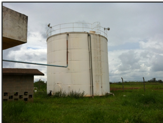
Figura 30. Reservatório apoiado metálico (300 m 3 )
