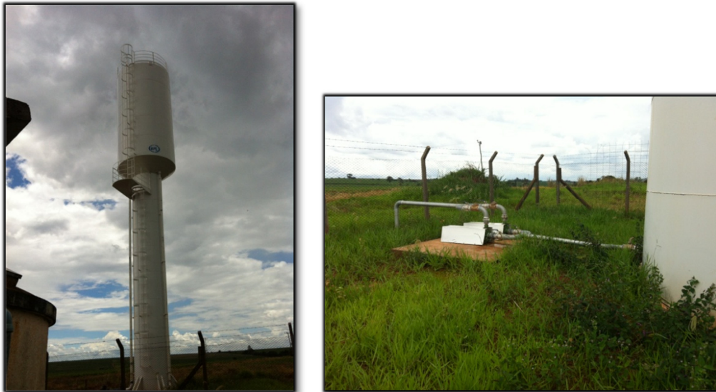
Figura 32. Reservatório elevado metálico (50 m 3 ) e sua elevatória
