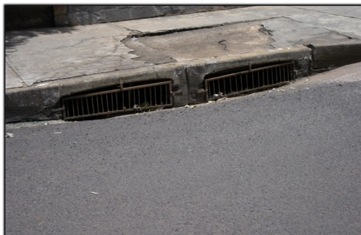
Figura 115. Galeria 5 - Boca de lobo de guia dupla na Rua Osvaldo Pongetti
