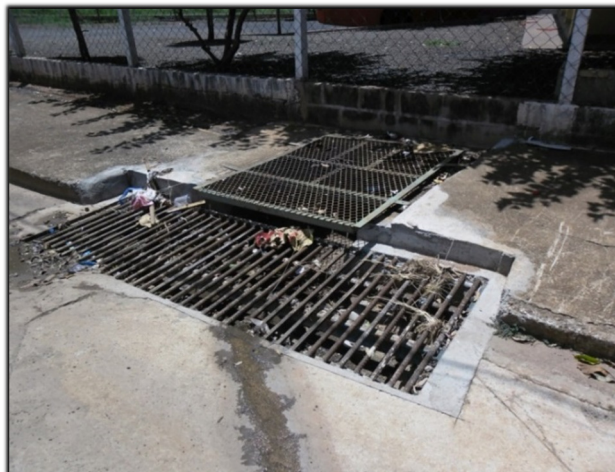
Figura 103. Galeria 2 - Boca de lobo com boca composta por grandes grelhas.
