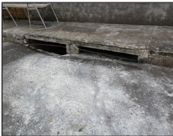
Figura 120. Galeria 6 – boca de lobo “dupla” de guia – à direita da condução
