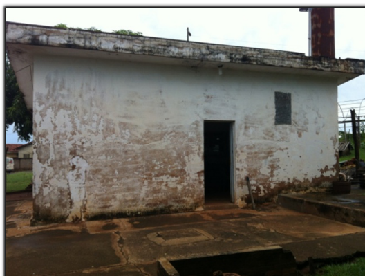
Figura 51. Casa de máquinas
