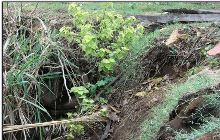
Figura 116. Galeria 5 – Ponto de Lançamento – instalação de processo erosivo – PL5 – STP
