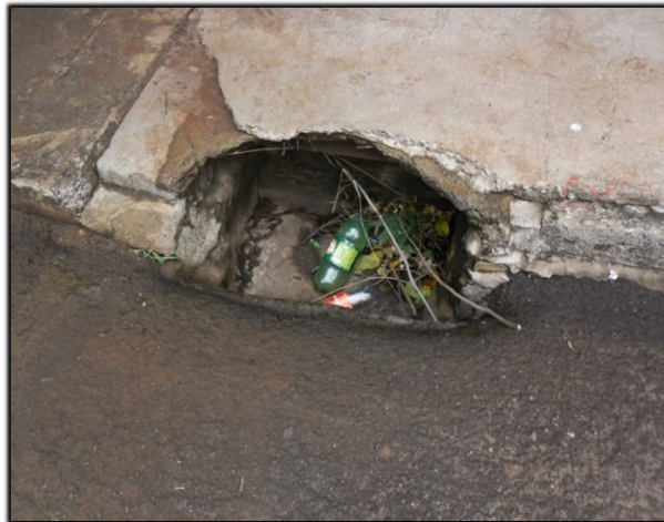
Figura 121. Galeria 6 – boca de lobo simples de guia – à direita da condução
