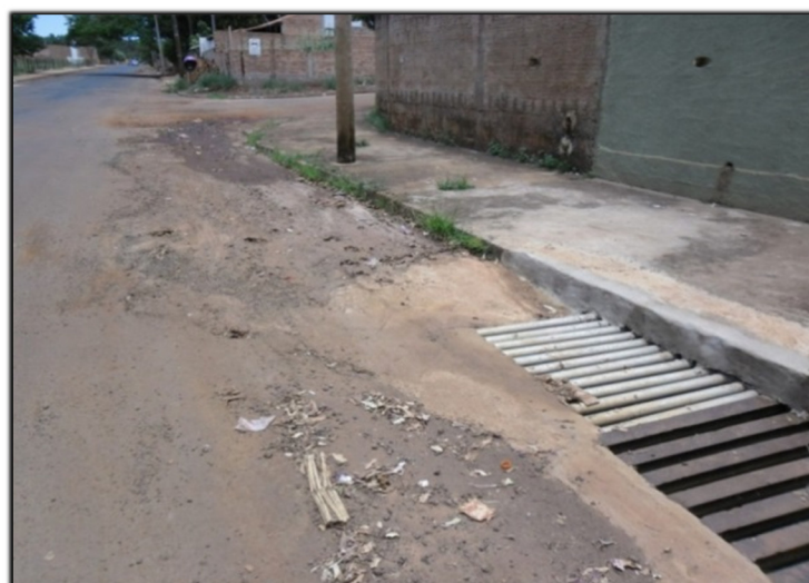
Figura 90. Boca de lobo com grelha em ponto intermediário
