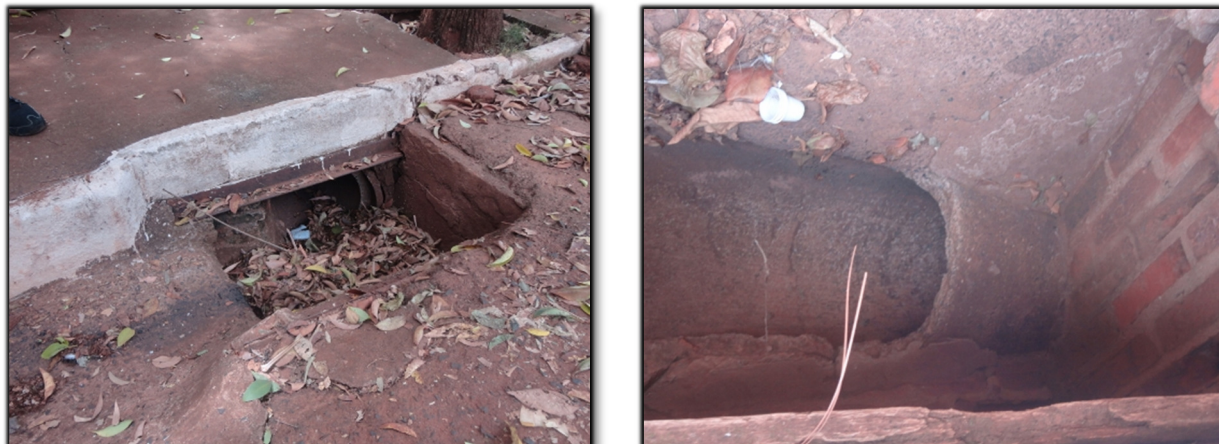
Figura 180. Boca de lobo sem grelhas, quase obstruídas e com problemas estruturais
