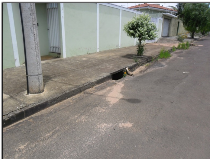
Figura 111. Galeria 4 - Boca de lobo de guia.
