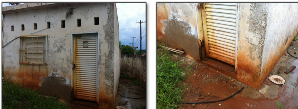
Figura 44. Casa de máquinas
