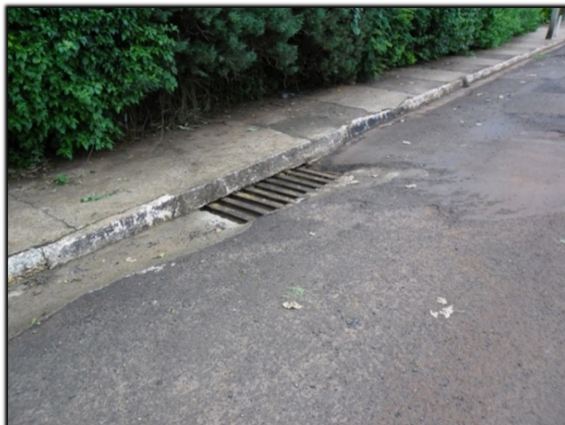
Figura 106. Galeria 3 - Boca de lobo simples com boca grelha.
