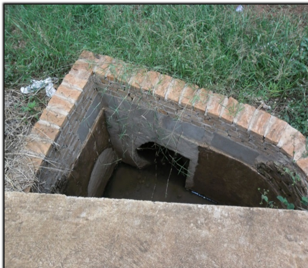
Figura 157. Bloco III – Galeria 9 – Caixa de Passagem – aberta e função ignorada.
