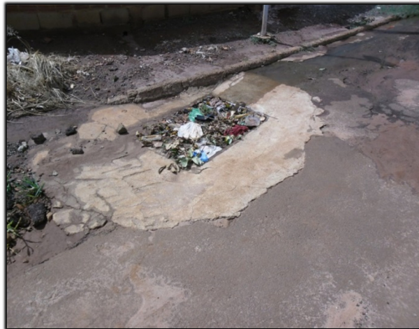
Figura 154. Galeria 9 – boca de lobo simples de grelha – acumulo de resíduos
