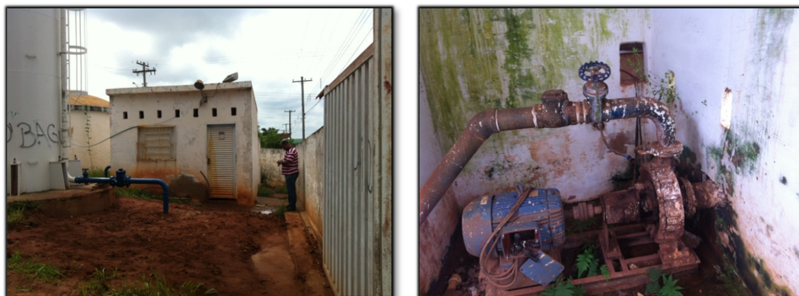
Figura 27. Casa de máquinas e elevatória (Sist. 13 de Maio)
