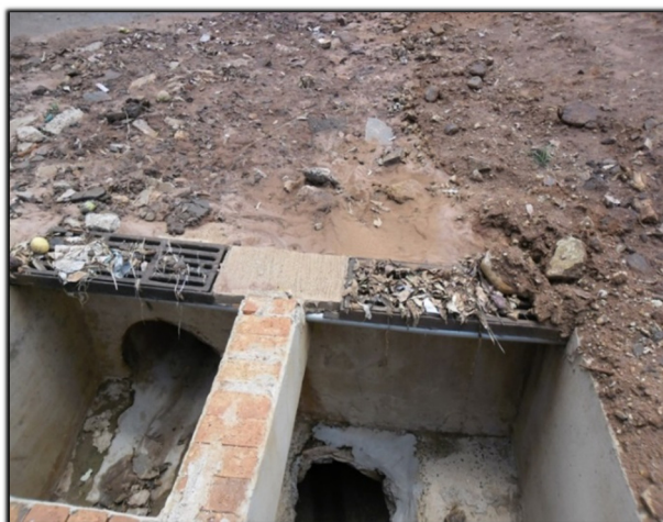
Figura 131. Galeria 7 – Boca de lobo dupla de grelha – ausência de grelhas – e problemas estruturais.
