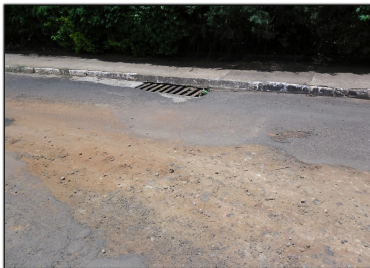
Figura 92. Boca de lobo com boca grelha em ponto baixo
