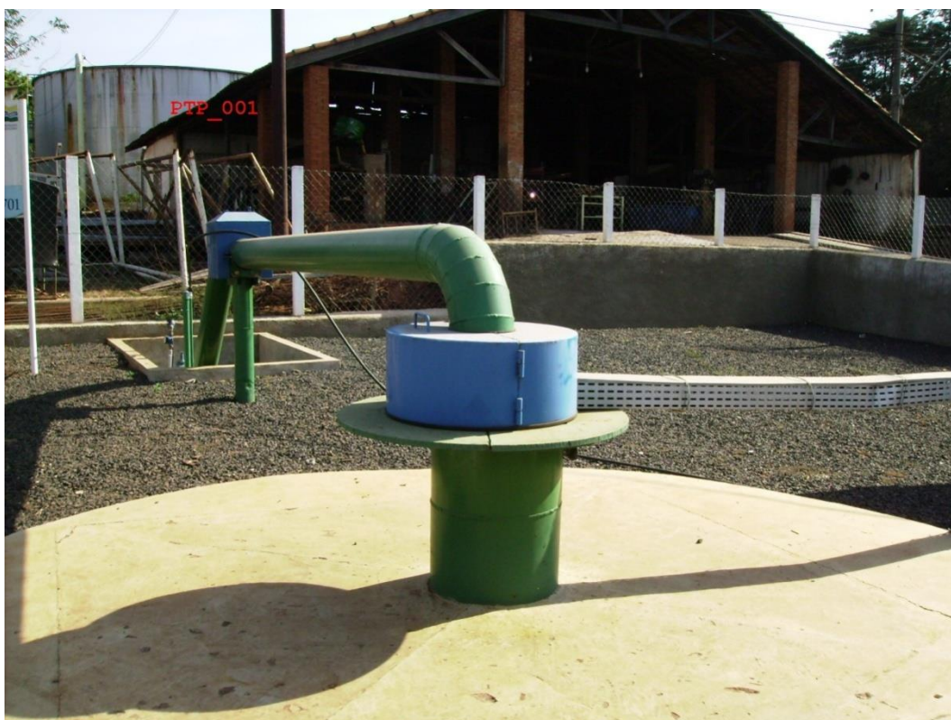
FIGURA 5- 7: BARRILETE DE SAÍDA DO POÇO P01
