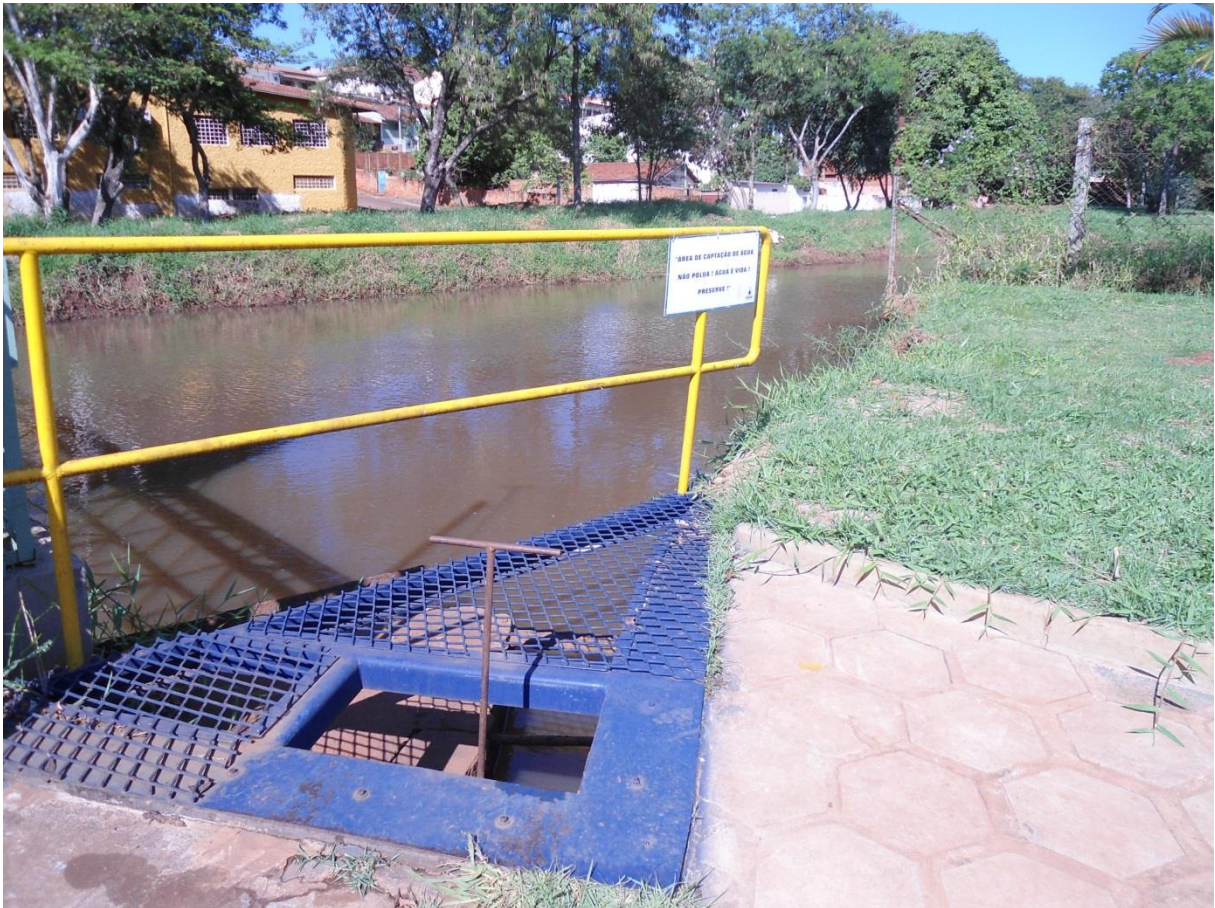
FIGURA 5- 2: FOTO DA TOMADA DE ÁGUA DA CAPTAÇÃO DO RIO LENÇÓIS
