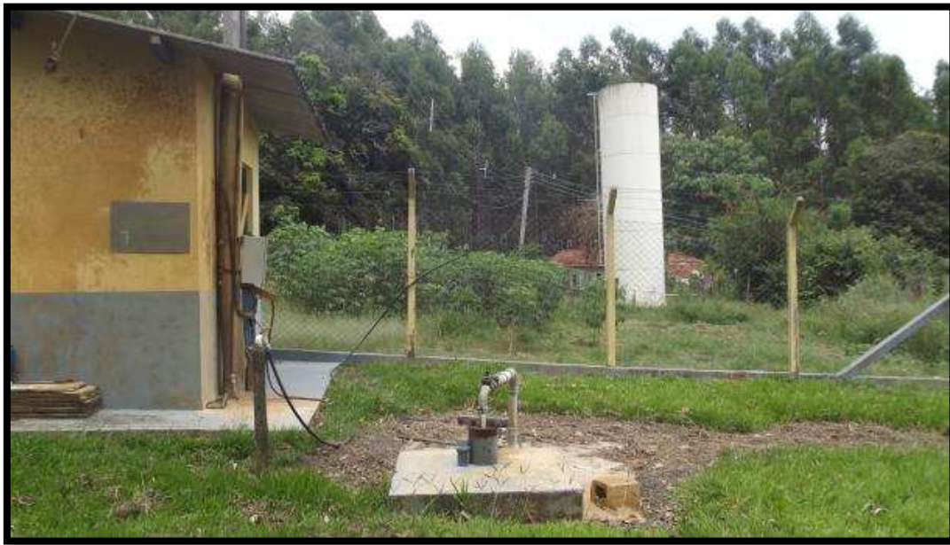
Figura 8 - Poço 07 e Reservatório 08 – Rua 02 Itaqueri da Serra
