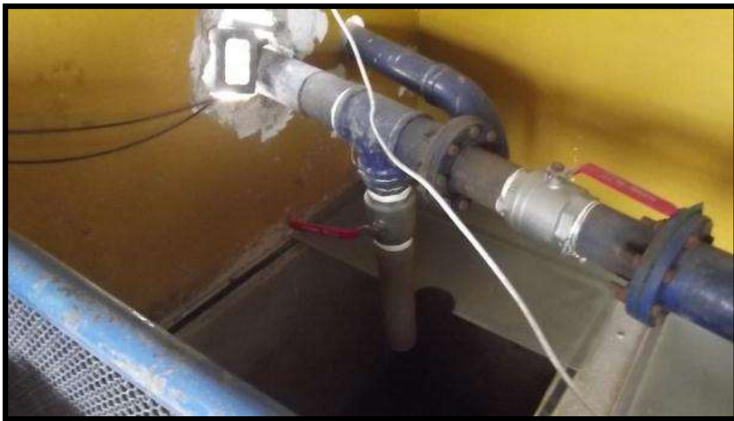
Figura 11 - Decantador do Poço 09, Reservatório 02
