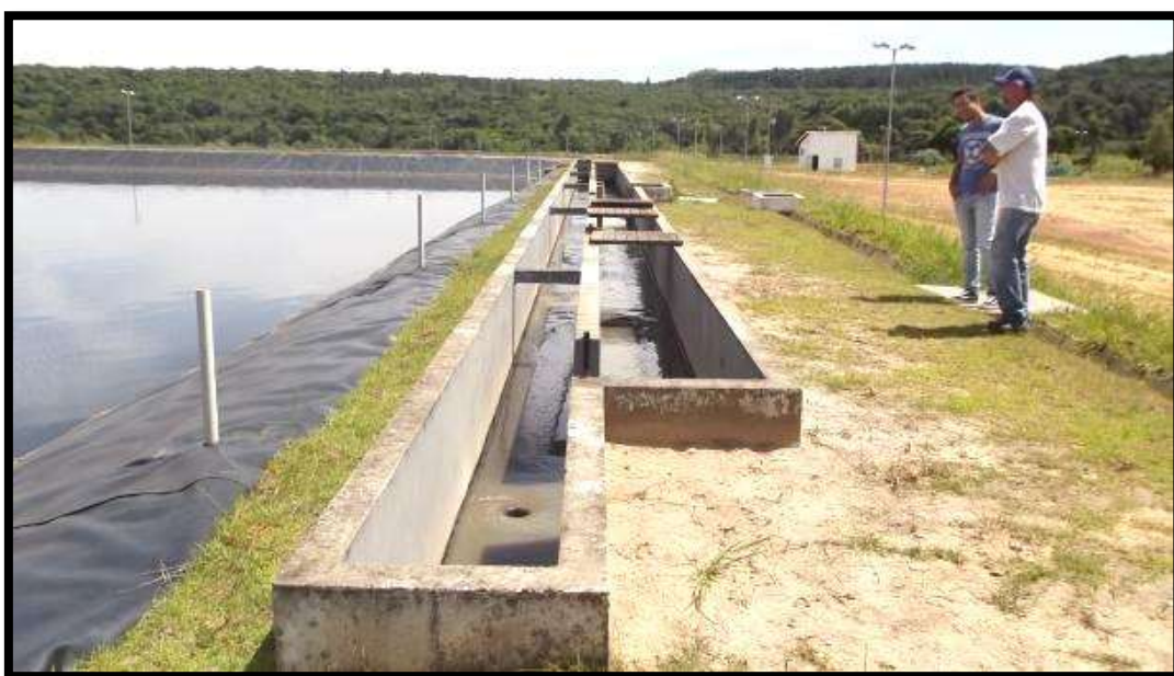
Figura 25 - Canaleta de distribuição da Lagoa Anaeróbia
