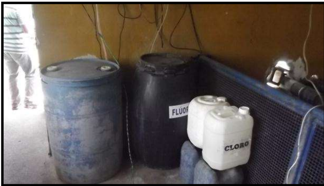
Figura 12 - Dosagem de Cloro e Flúor Poço 09, Reservatório 02
