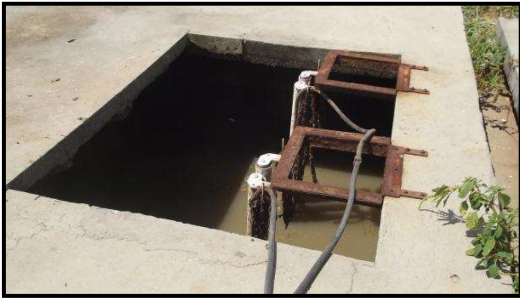
Figura 30 - Estação Elevatória da ETE
