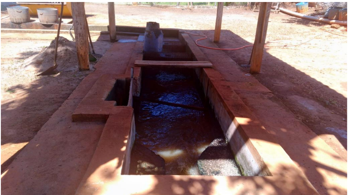
Imagem 24 – Sistema preliminar (caixa de gradeamento)
