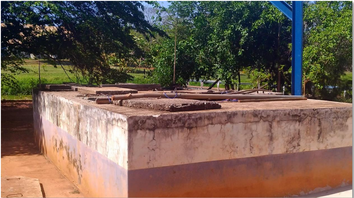
Imagem 23 – Estação Elevatória de Esgoto 2
