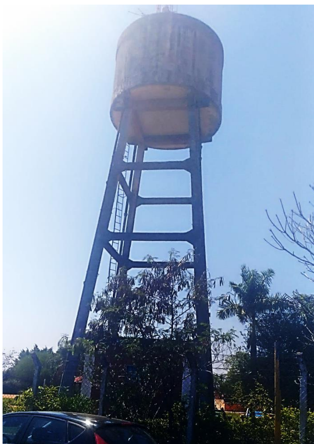
Imagem 20 – Reservatório Av. Primavera (R11) - Desativado
