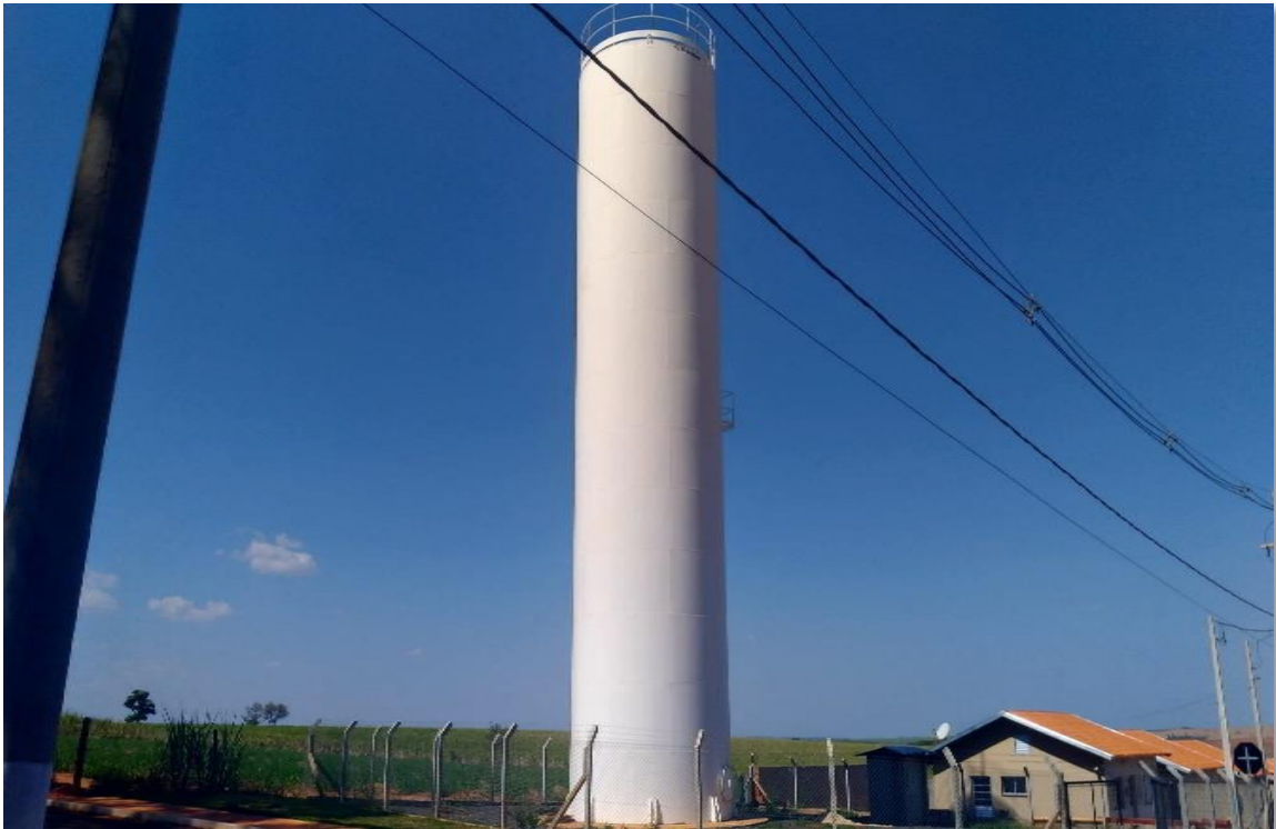
Imagem 18 – Reservatório Jardim Alvorada (R9)
