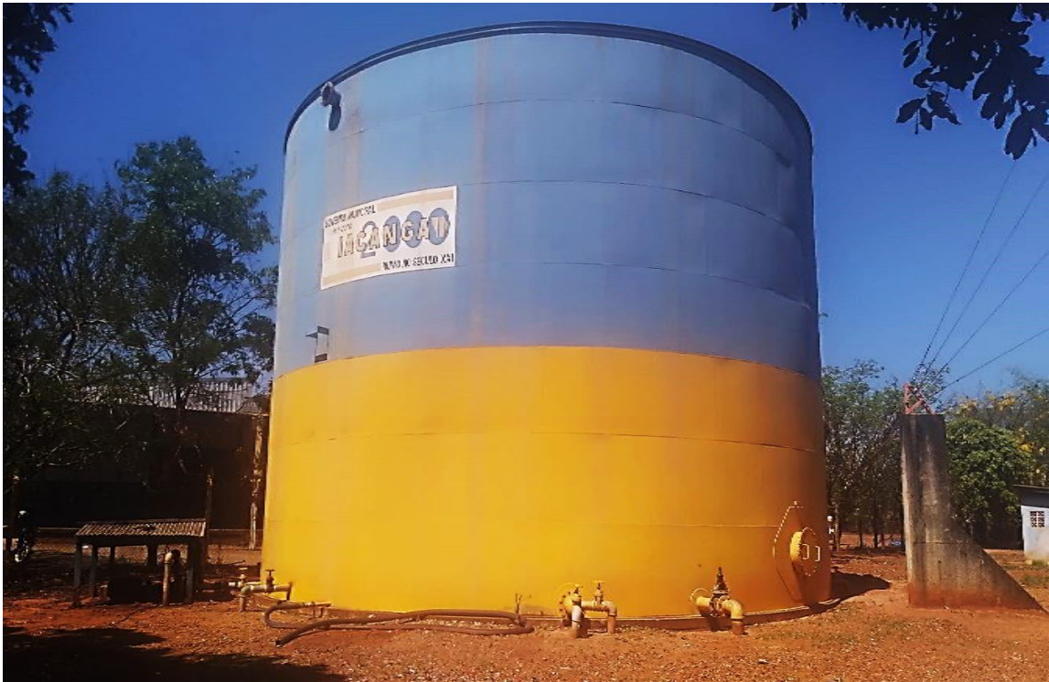
Imagem 12 – Reservatório Avenida Perimetral (R3)
