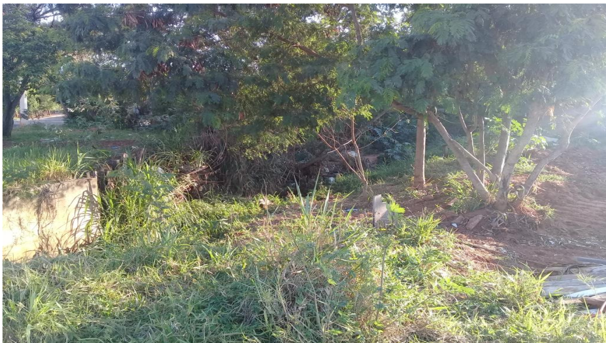
Imagem 32 – Ponto crítico 1: Rua Abílio Ticianeli (Trecho entre a Rua 9 de Julho até a Rua Monsenhor João Felipe)
