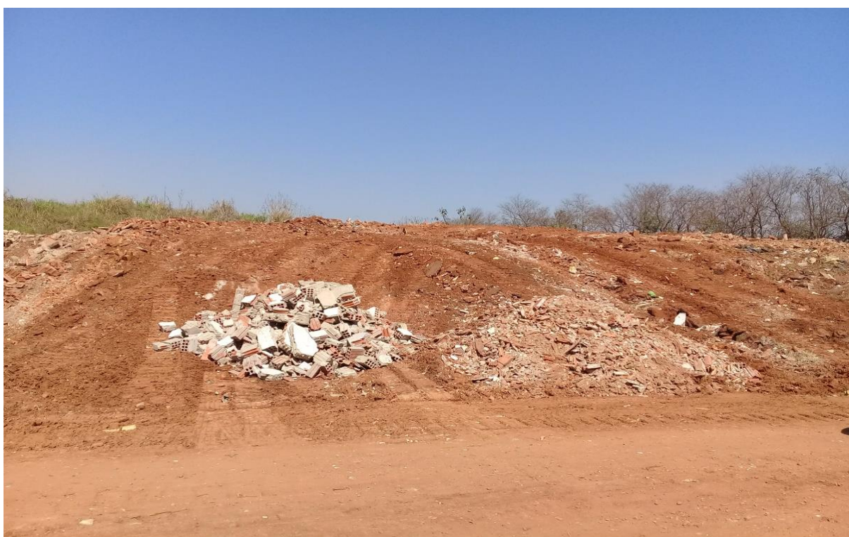
Imagem 58 – Área de triagem dos RCC
