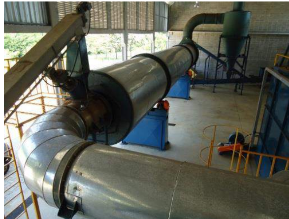
Foto 6.3.2.2-4 Sistema de Desaguamento e Secagem Térmica do Lodo
