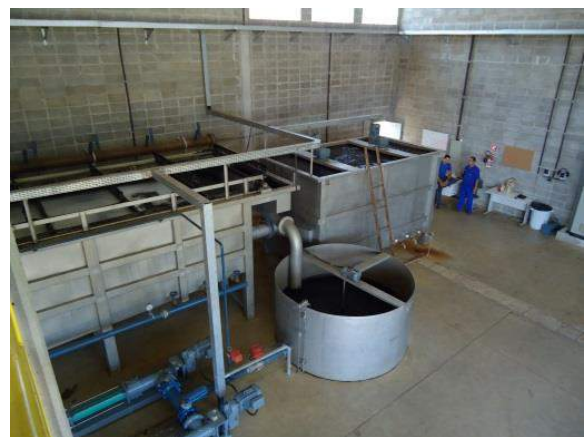
Foto 6.3.2.2-3 Sistema de Desaguamento e Secagem Térmica do Lodo
