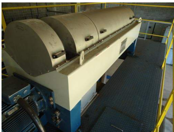
Foto 6.3.2.2-2 Sistema de Desaguamento e Secagem Térmica do Lodo
