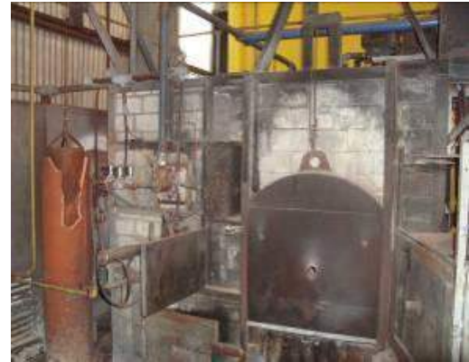
Foto 8.1.4.3-4 Incinerador desativado temporariamente
