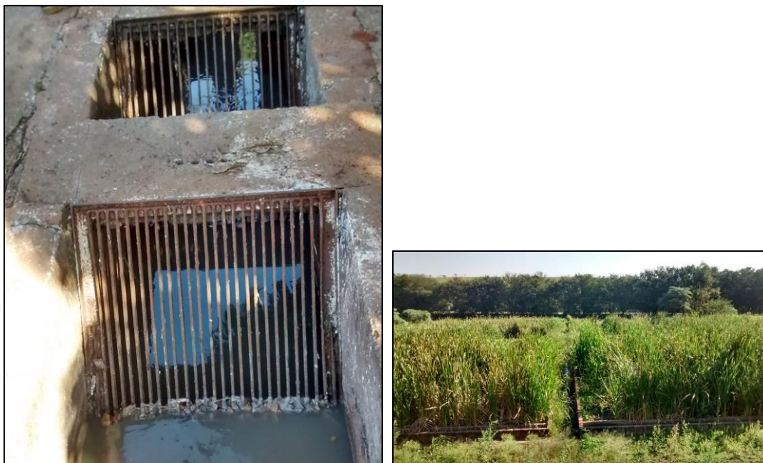
Figura 67 e 68: Estação de tratamento de esgoto Guarapuã - Fonte: Autor.
