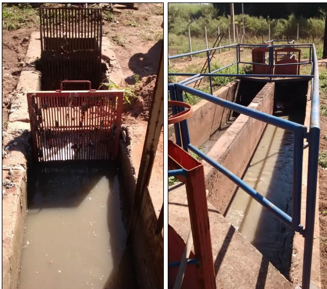
Figura 60 e 61: Sistema Preliminar de tratamento grade e caixa de areia (estação elevatória) - Fonte: Autor.
