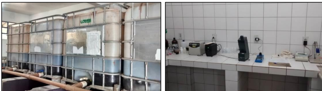
Figura 58 e 59: Equipamentos Estação de Tratamento de Água - ETA - Fonte: Autor.
