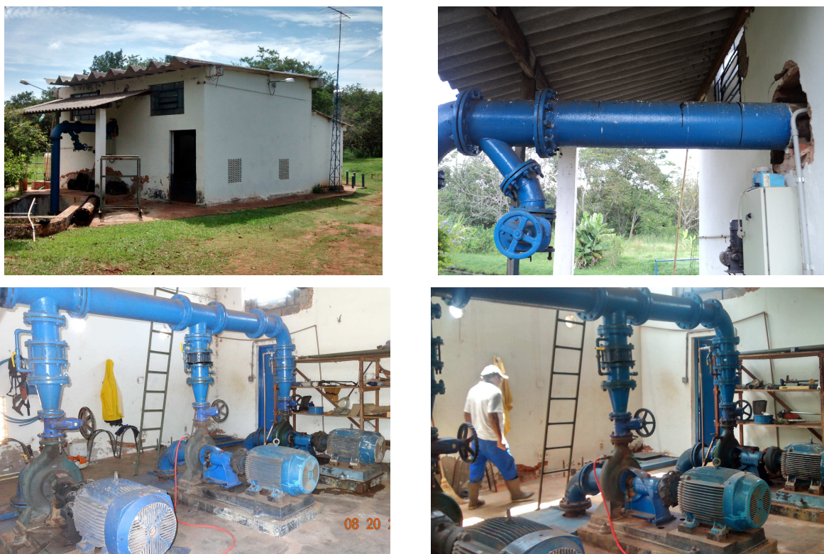
Figura 3.4 - Casa de bombas na captação de água bruta do manancial São Luiz (Fonte: arquivo Hidrosan, 2013)
