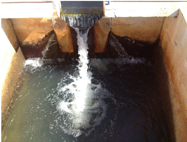
Vertedor de entrada nos filtros
