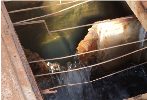
Vertedor de água filtrada de um módulo
