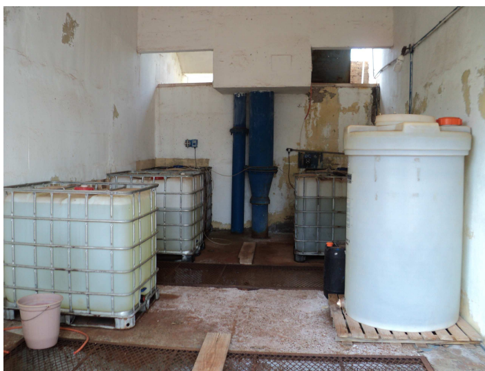
Figura 3.12 - Armazenamento de produtos químicos (Fonte: arquivo Hidrosan, 2013)
