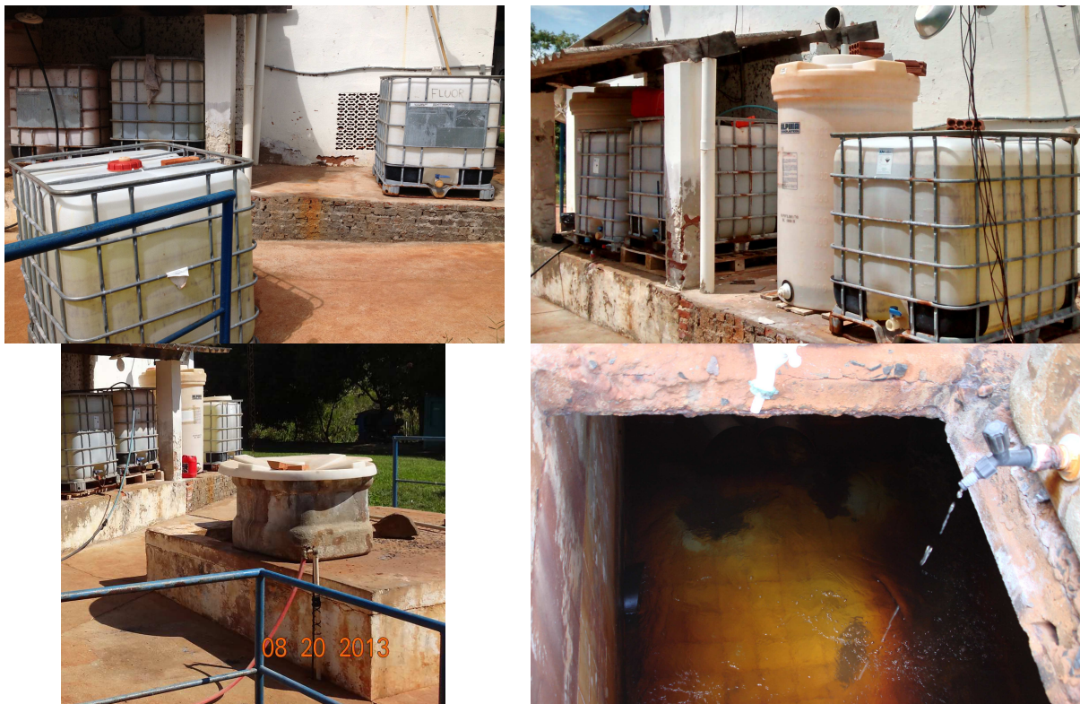
Figura 3.5 - Armazenamento e dosagem de hipoclorito de sódio para pré-cloração da água bruta na captação (Fonte: arquivo Hidrosan, 2013 e 2014)
