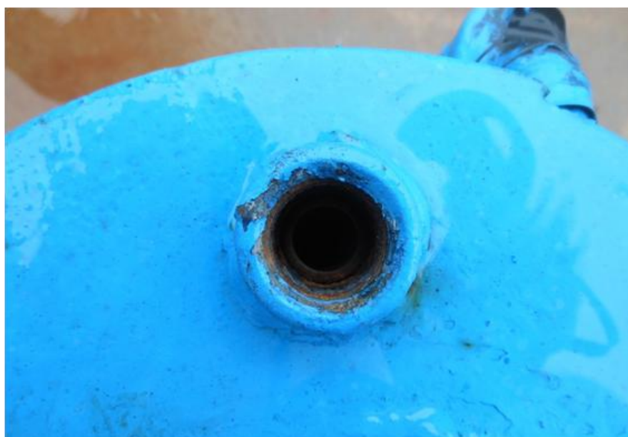
Figura 2.14 - Detalhe do Tubo de Medição de nível
