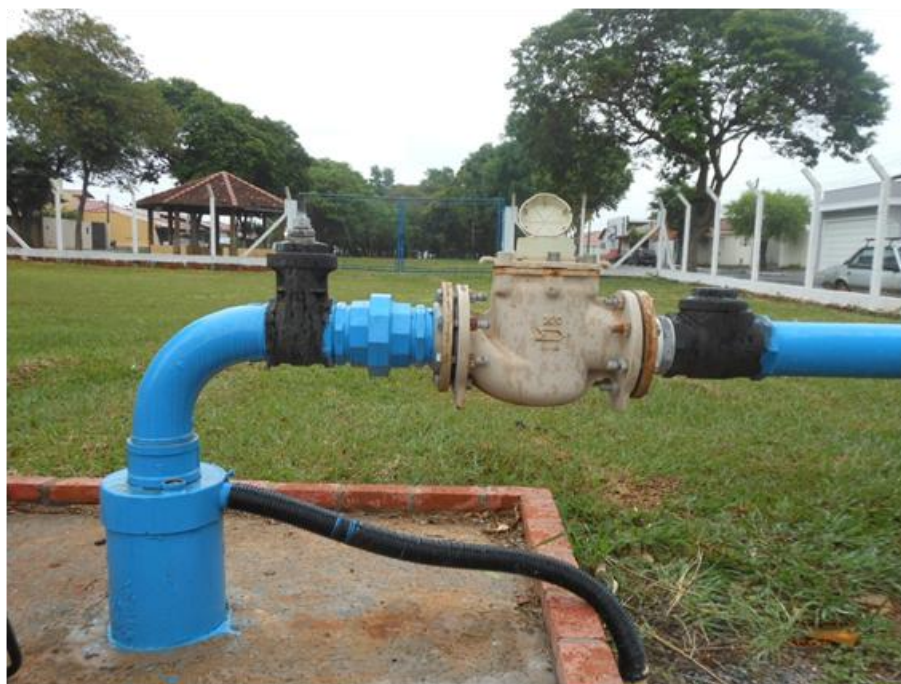
Figura 2.9 - Poço 6 - Nova Bariri
