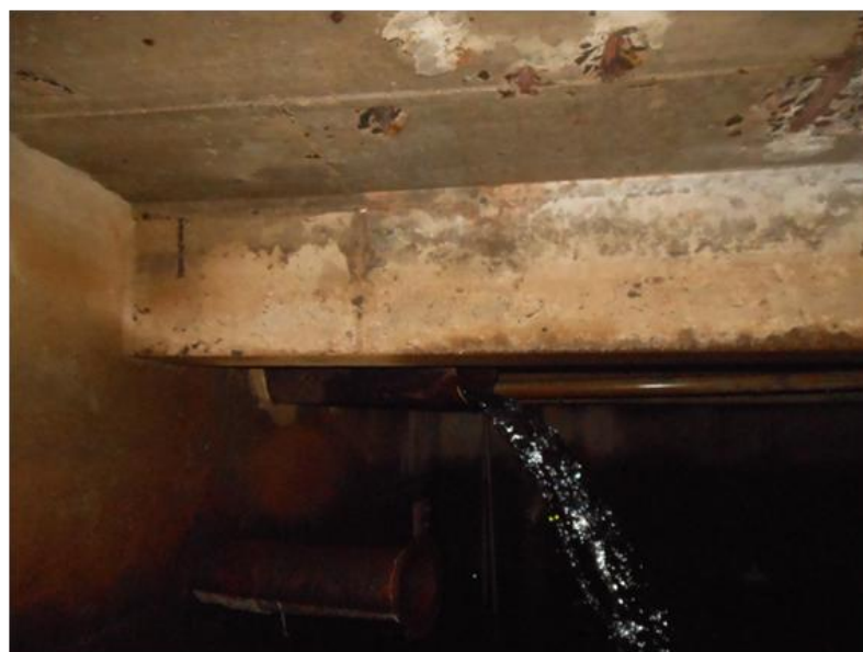
Figura 2.8 - Detalhe da chegada da água no reservatório
