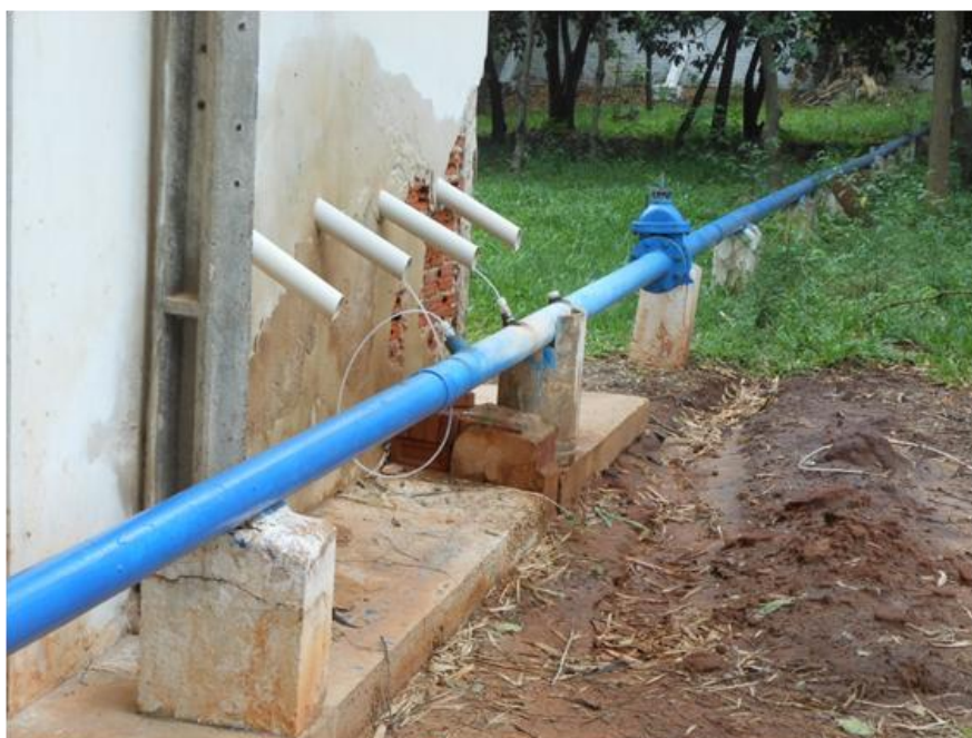
Figura 2.3 - Poço 3 - Detalhe dos pontos para cloração e fluoretação
