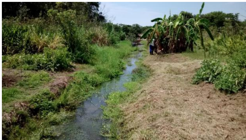
Figura 2.17 - Canal principal de encaminhamento da água ao poço de sucção (EEAB)
