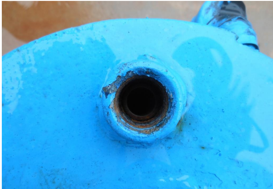
Figura 4.30 - Detalhe do Tubo de Medição de nível
