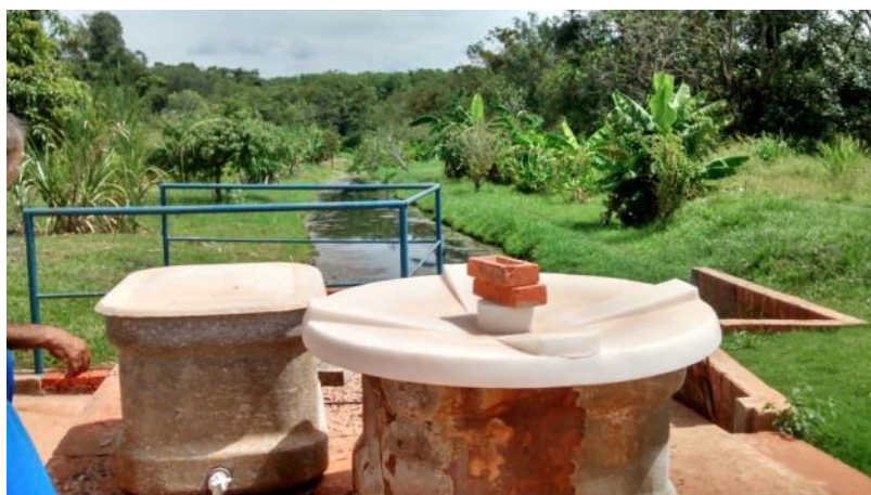
Figura 5.36 - Locais de dosagem de produtos químicos na captação
