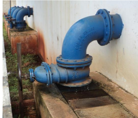
Vazamento na válvula de descarga de água de lavagem
