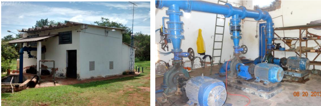
Figura 6.4 - Casa de bombas na captação de água bruta do manancial São Luiz (Fonte: arquivo Hidrosan, 2013)
