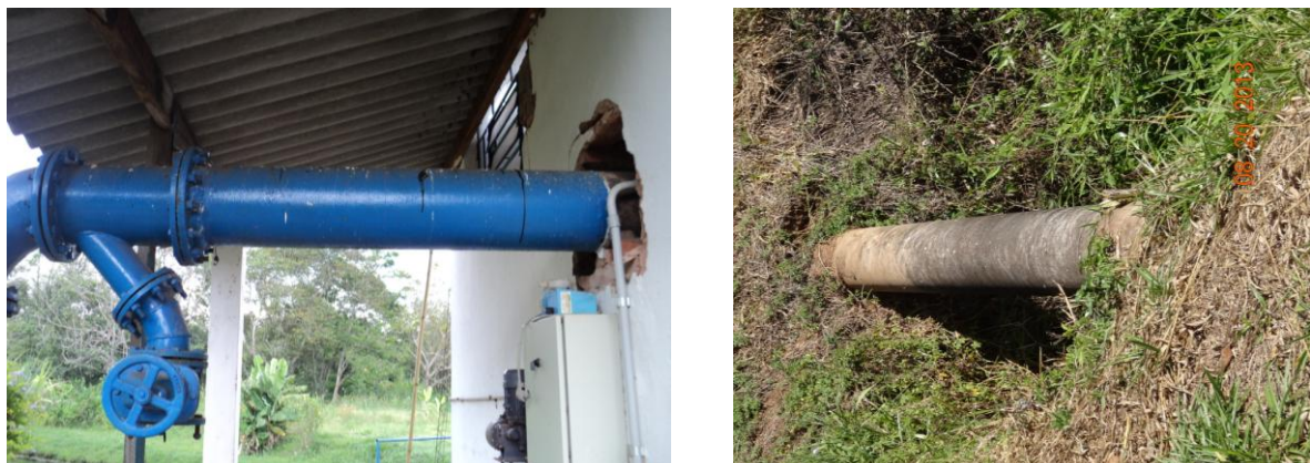
Trecho ferro fundido na saída da casa de bombas
