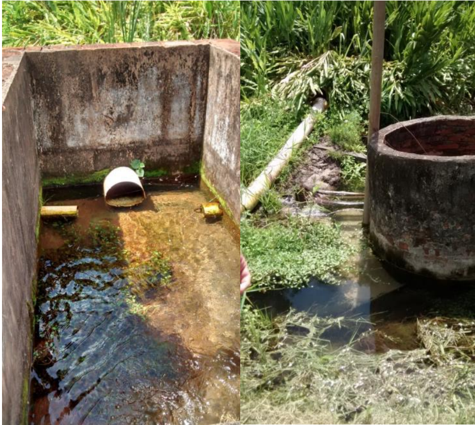
Figura 5.20 - Detalhes das tubulações que chegam às caixas de captação
