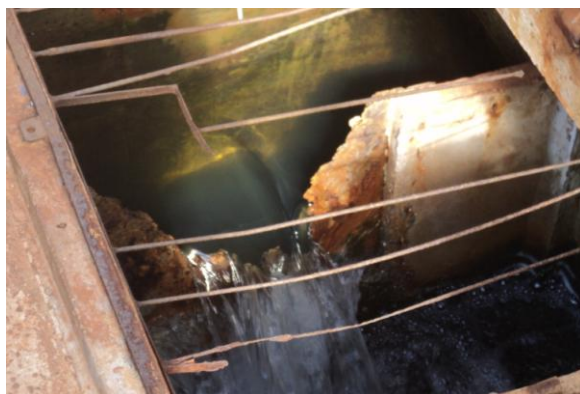
Vertedor de água filtrada de um módulo
