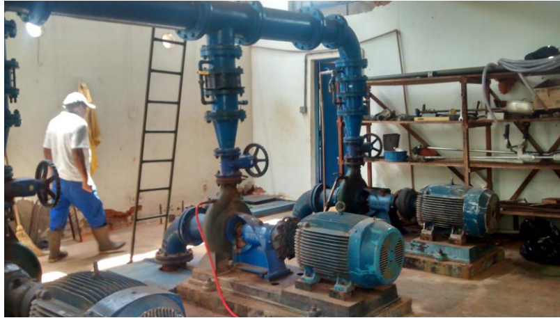
Figura 5.37 - Bombas da EEAB.
