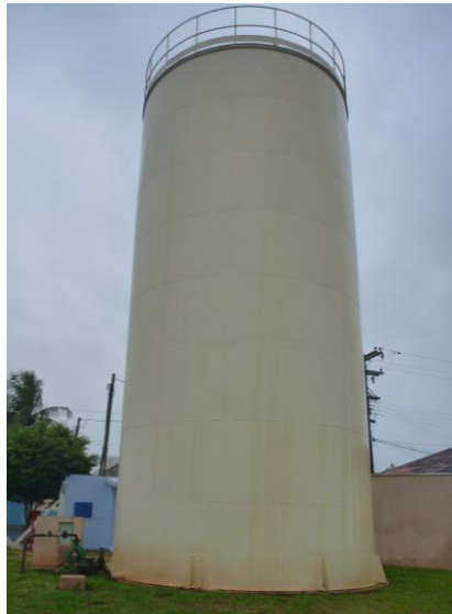
Figura 6.25 – Reservatório Jardim Maravilha/Ipês (Fonte: arquivo Hidrosan, 2013)
