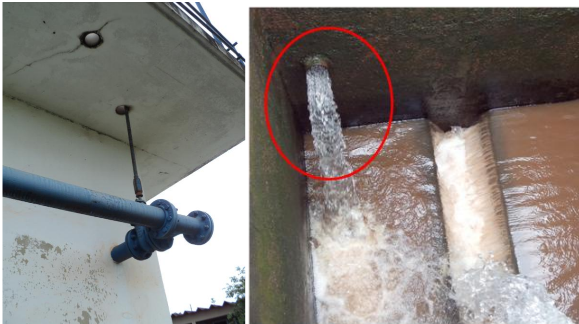
Figura 7.10 – Tubulação de comunicação entre os filtros aberta durante a lavagem
