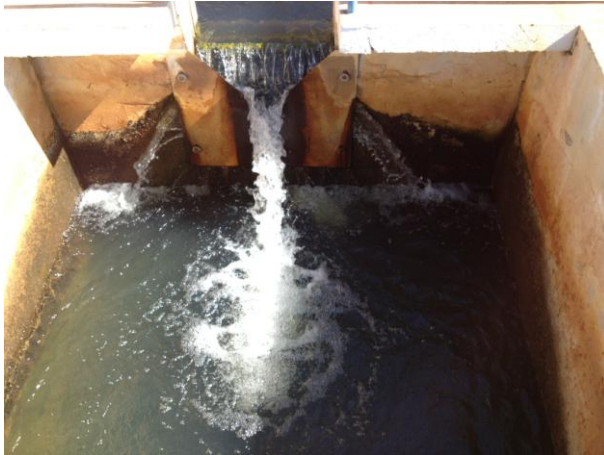
Vertedor de entrada nos filtros
