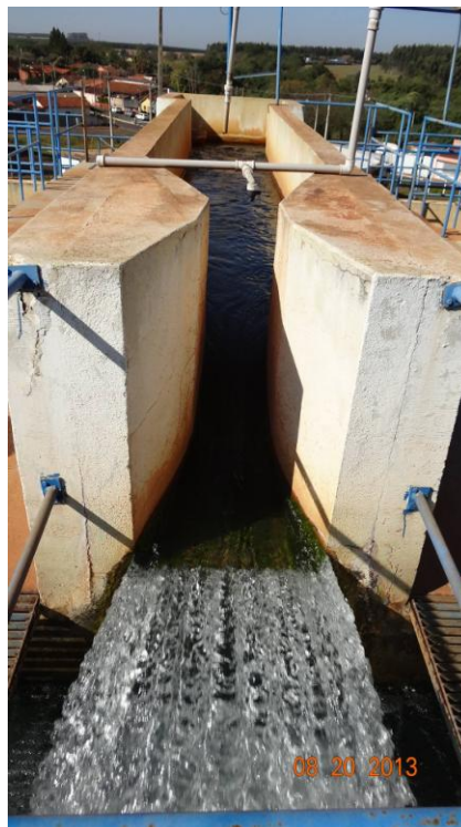
Figura 6.10 - Vertedor Parshall da ETA em funcionamento (Fonte: arquivo Hidrosan, 2013)
