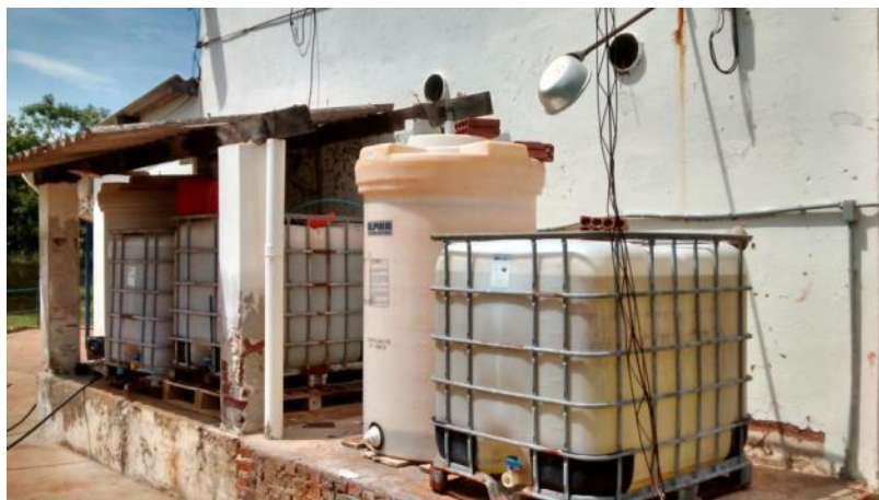
Figura 5.35 - Tanques de produtos químicos dosados na captação
