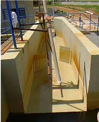
Locais de aplicação de produtos químicos – Antes do vertedor Parshall
