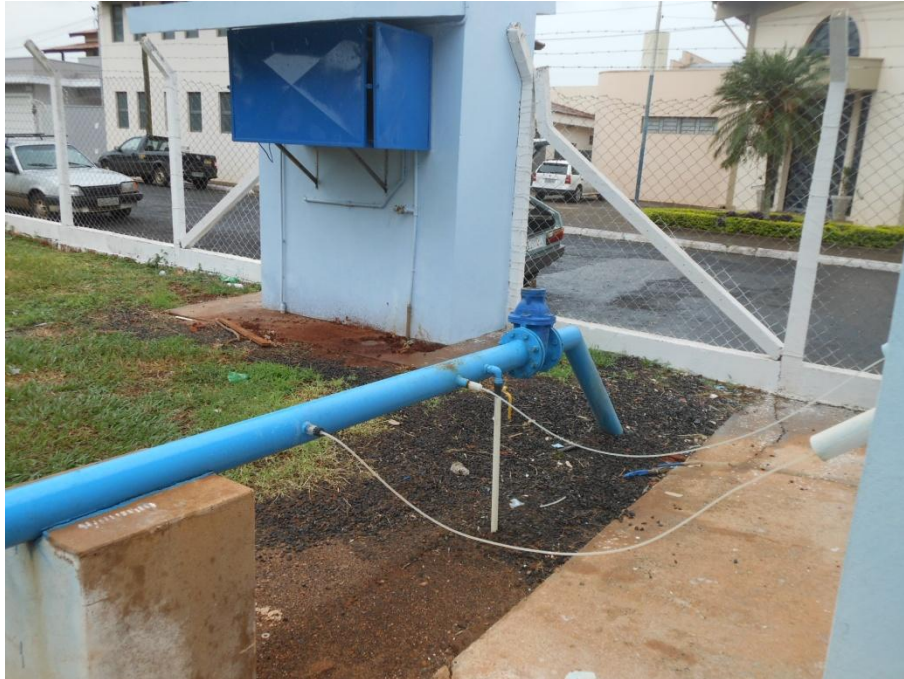
Figura 4.26 - Poço 6 – Pontos de cloração e fluoretação
