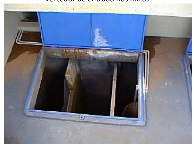
Caixa geral de saída de água filtrada
