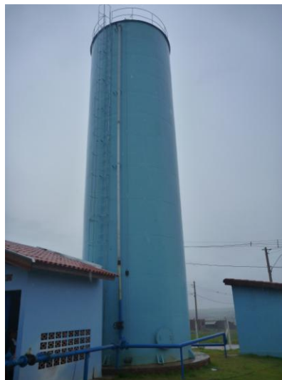
Figura 6.26 - Reservatório Maria Luiza II (Fonte: arquivo Hidrosan, 2013)
