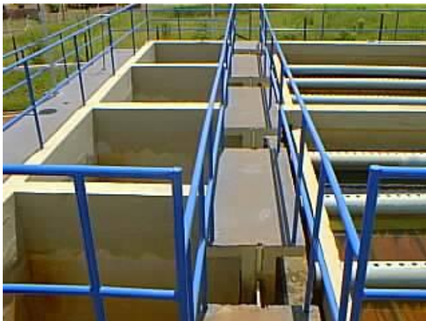
Vista geral dos filtros e canal de alimentação
