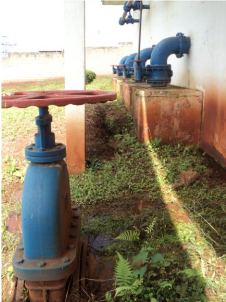
Vazamento entre a saída da câmara geral de água filtrada e válvula da tubulação de encaminhamento
