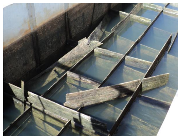
Mau estado de conservação das madeiras
