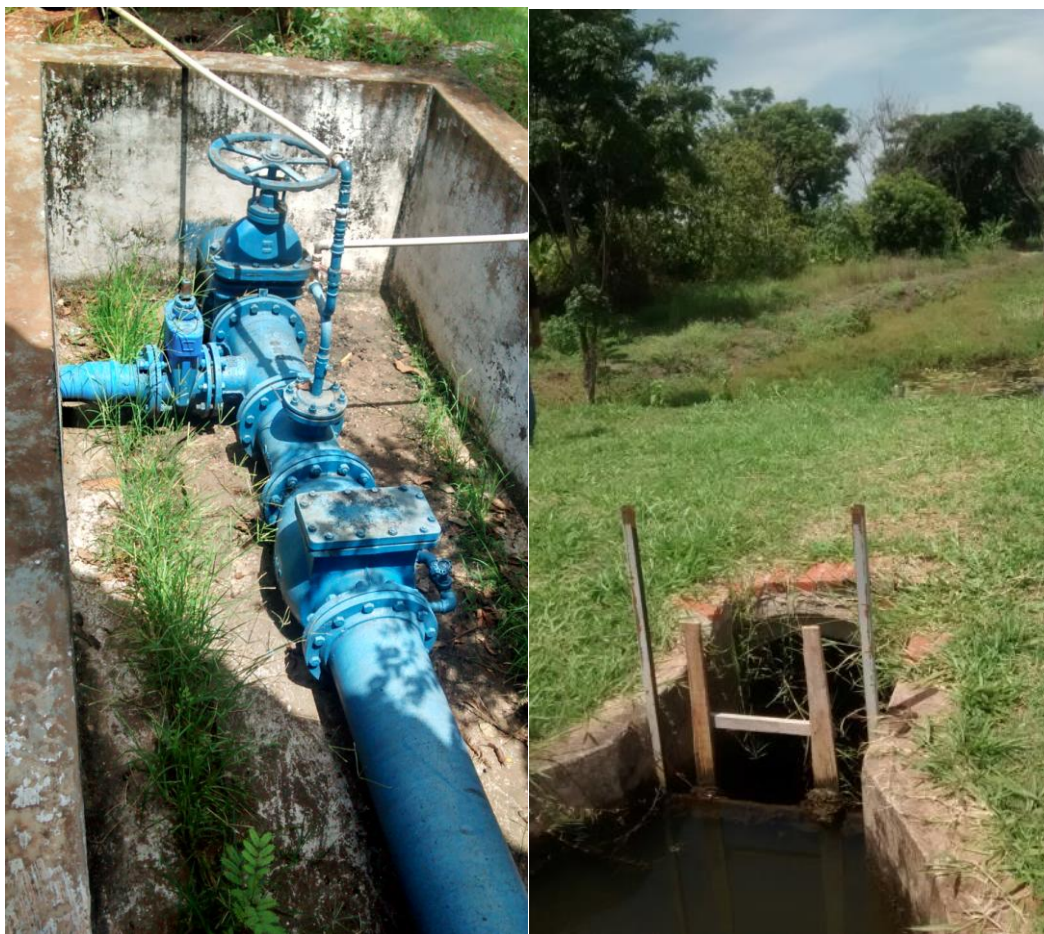
Figura 5.38 - Tubulação de início da adutora de água bruta até o sistema de tratamento e vertedor de saída da água excedente que não é encaminhada à ETA
