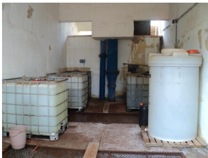
Figura 6.19 - Armazenamento de produtos químicos (Fonte: arquivo Hidrosan, 2013)
