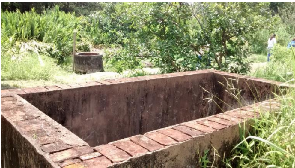
Figura 5.19 - Caixas de captação de água em que chegam as tubulações vindas das nascentes
