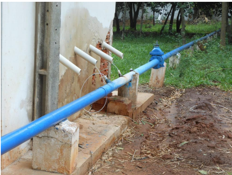
Figura 4.20 - P 3 - Detalhe dos pontos para cloração e fluoretação
