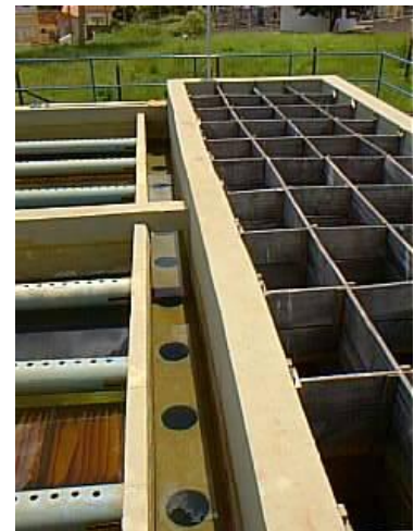
Canal de interligação da unidade de floculação com os decantadores
