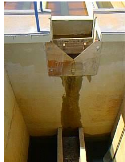
Vertedor de entrada nos filtros
