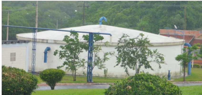
Figura 6.21 – Reservatório da ETA (Fonte: arquivo Hidrosan, 2013)
