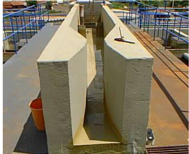
Vertedor Parshall – Saída do vertedor Parshall
