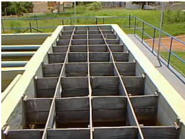
Unidade de floculação hidráulica em canais com chicanas
