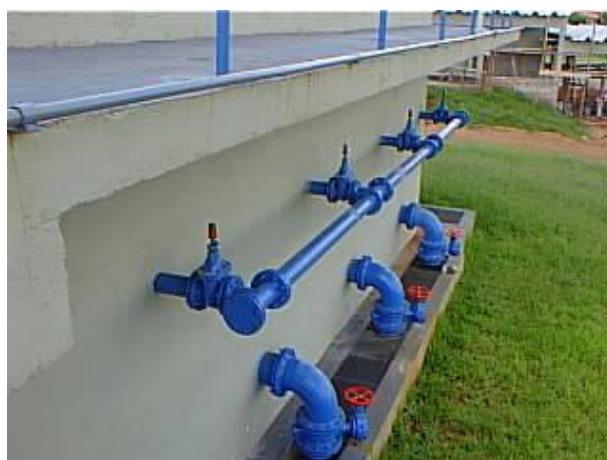
Interligação das saídas dos filtros
