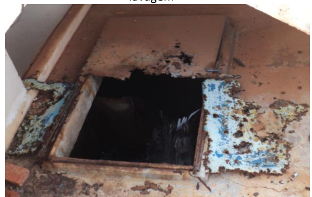
Tampa da câmara geral de água filtrada
