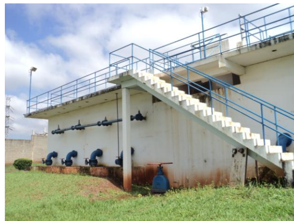
Vista lateral da ETA
