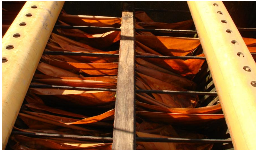
Figura 6.15 - Deterioração dos suportes e lonas do decantador (Fonte: arquivo Hidrosan, 2014)
