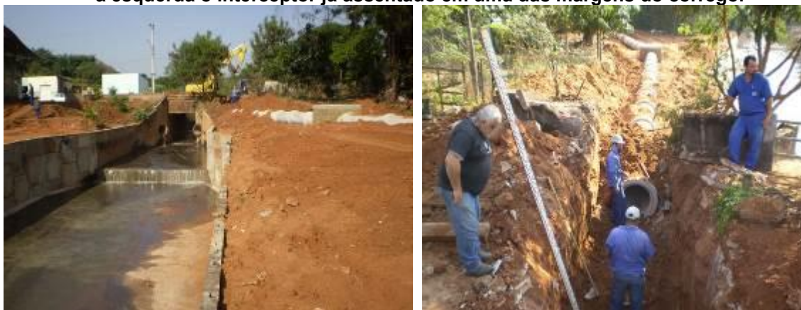
Figura 353: Fotos das obras de implantação do Interceptor Córrego Água do Sobrado. Na foto à esquerda o interceptor já assentado em uma das margens do córrego.
