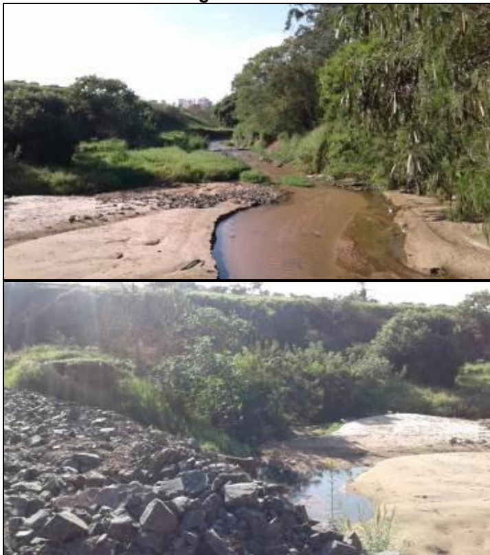
Figura 529 – Fundo de vale Córrego da Grama – Av. Daniel Pacífico – Risco A.
