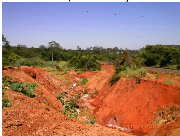
Figura 573 – Danos causados pela Chuva em janeiro – Distrito Industrial.
