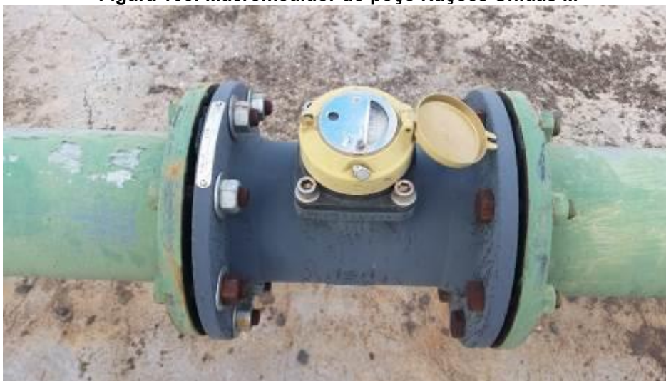
Figura 105: Macromedidor do poço Nações Unidas II.
