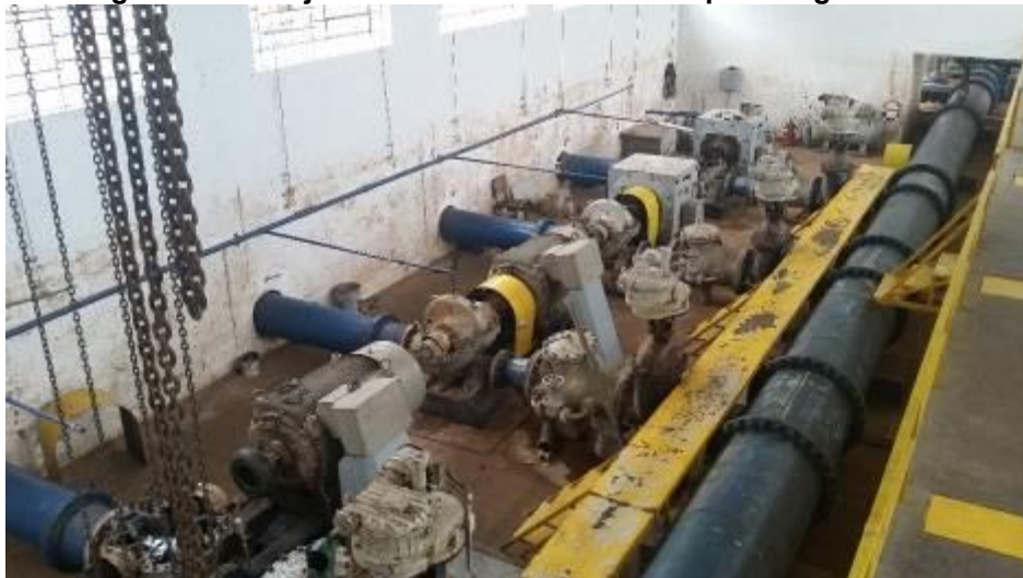
Figura 225: Conjuntos moto bomba do recalque de água bruta.
