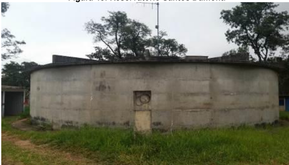
Figura 45: Reservatório Santos Dumont.
