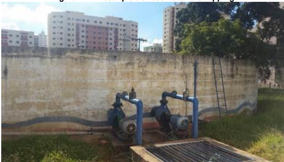
Figura 112: Recalque do reservatório Shopping.
