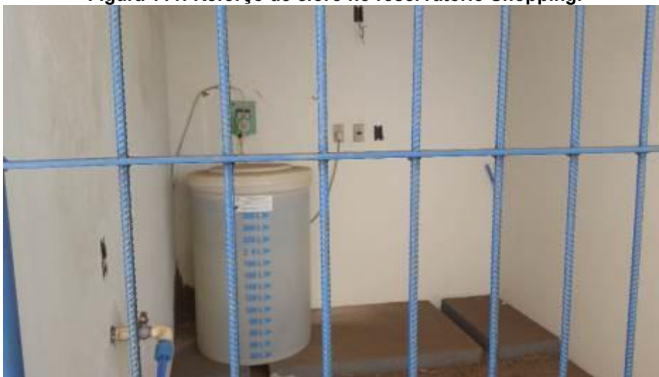
Figura 111: Reforço de cloro no reservatório Shopping.
