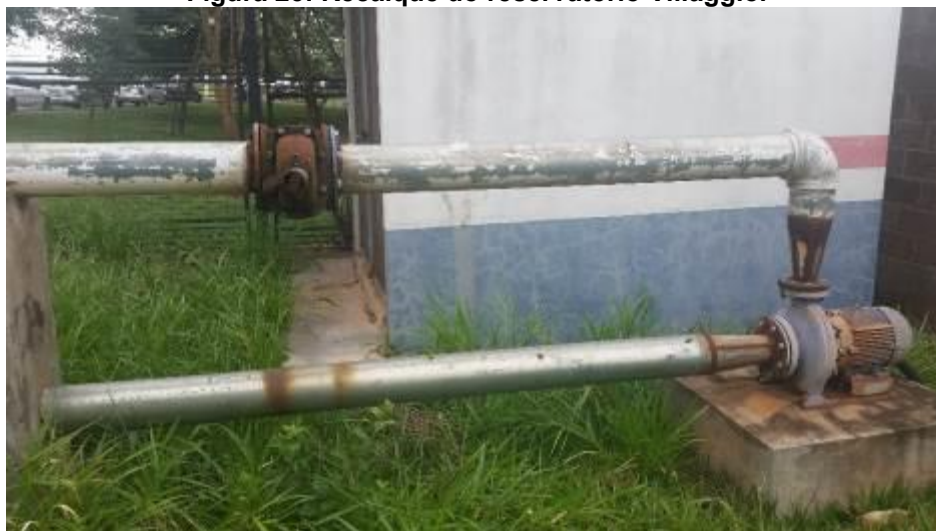
Figura 23: Recalque do reservatório Villaggio.
