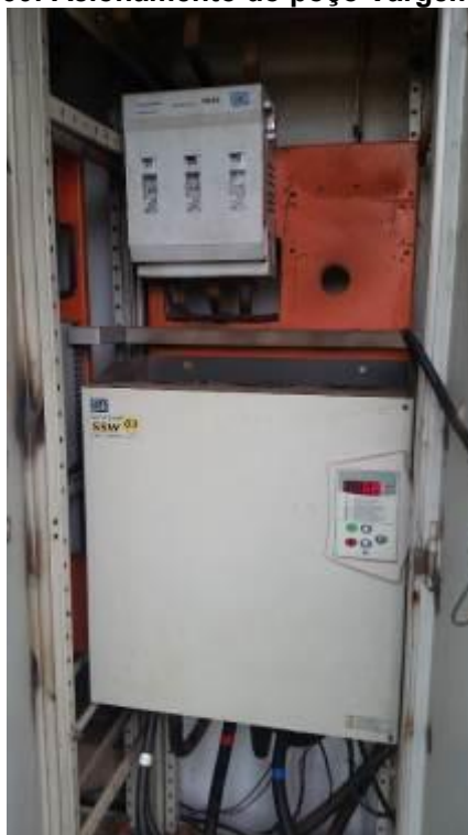
Figura 60: Acionamento do poço Vargem Limpa.
