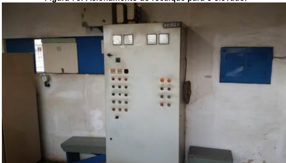
Figura 78: Acionamento do recalque para o elevado.
