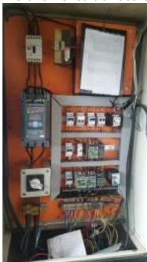
Figura 206: Acionamento do recalque Jardins.
