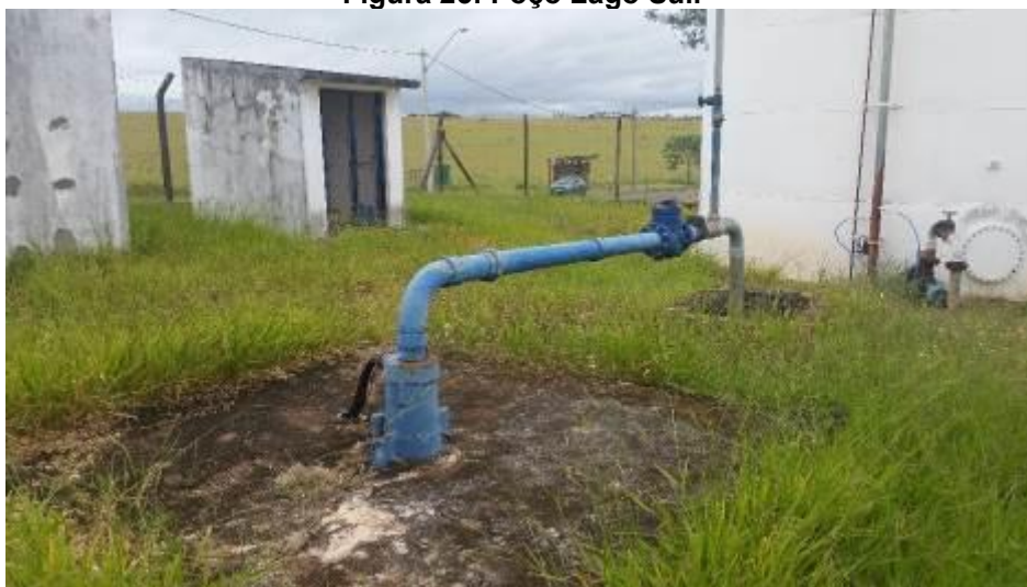
Figura 25: Poço Lago Sul.
