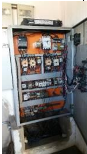
Figura 214: Acionamento do recalque Bela Vista.
