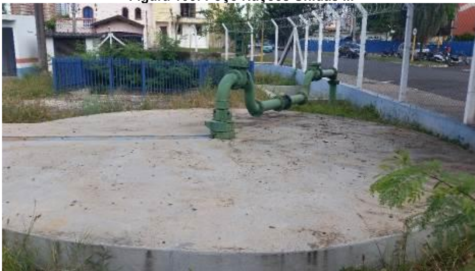
Figura 103: Poço Nações Unidas II.
