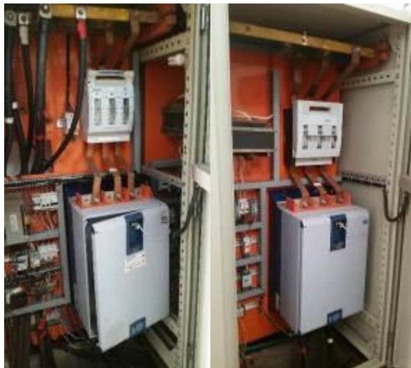
Figura 149: Sistema de acionamento da UP 40 e recalque.
