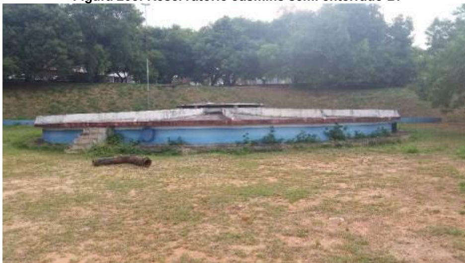
Figura 203: Reservatório Jasmims semi enterrado B.
