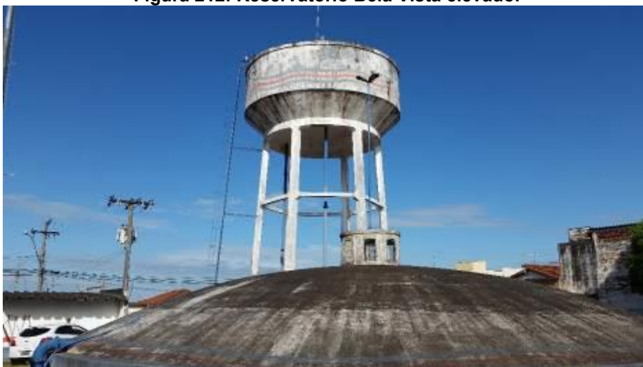
Figura 212: Reservatório Bela Vista elevado.
