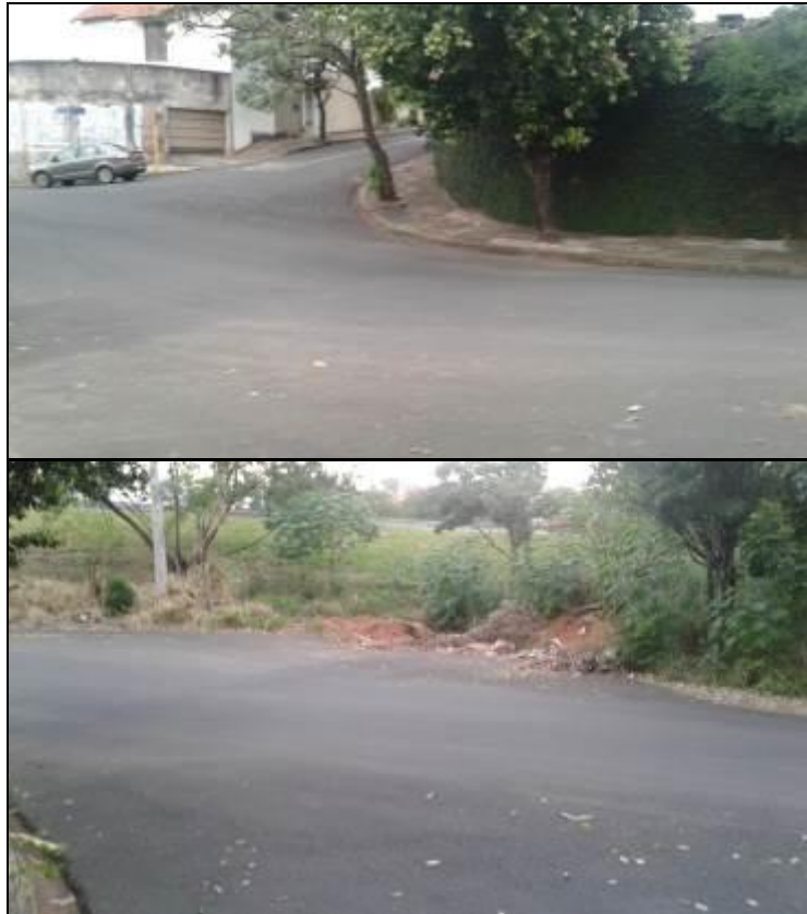
Figura 522 – Rua Gomes Berriel – Alameda Bentônias e Carmolina – Risco A.
