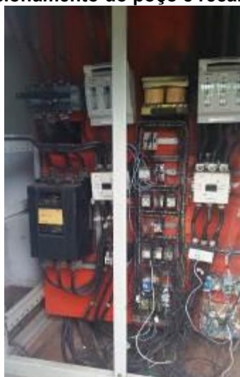
Figura 194: Acionamento do poço e recalque Beija Flor.
