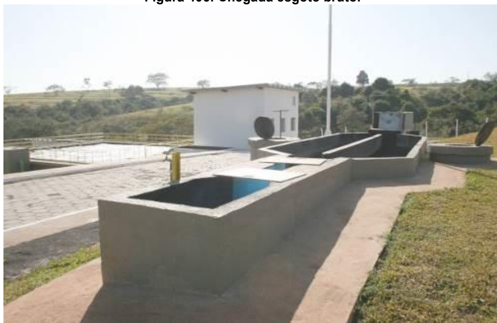
Figura 406: Chegada esgoto bruto.
