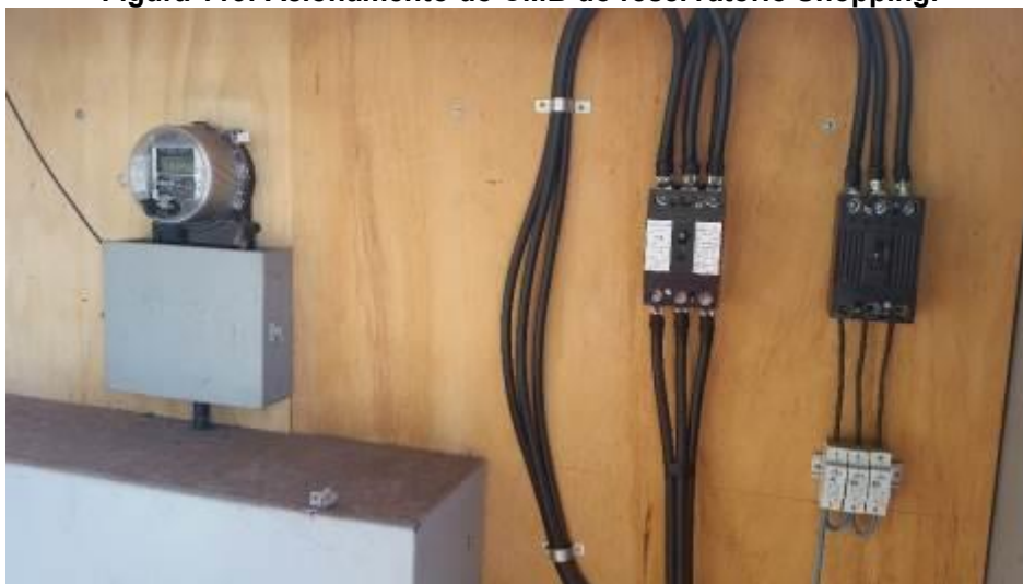
Figura 113: Acionamento do CMB do reservatório Shopping.
