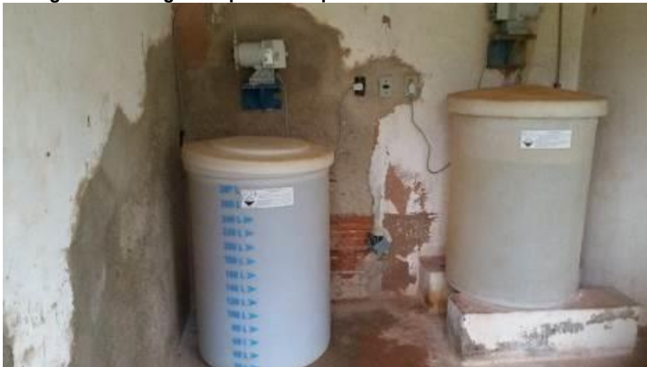
Figura 34: Abrigo dos produtos químicos do sistema Samambaia II.
