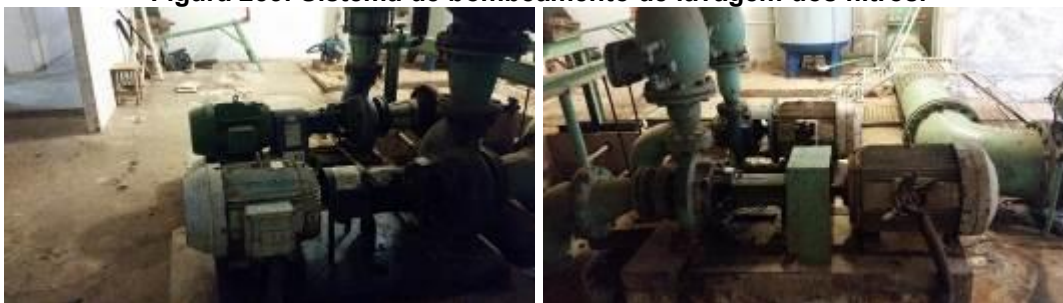
Figura 253: Sistema de bombeamento de lavagem dos filtros.
