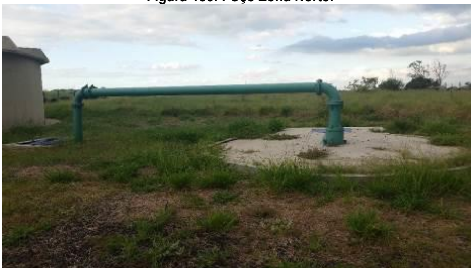
Figura 136: Poço Zona Norte.
