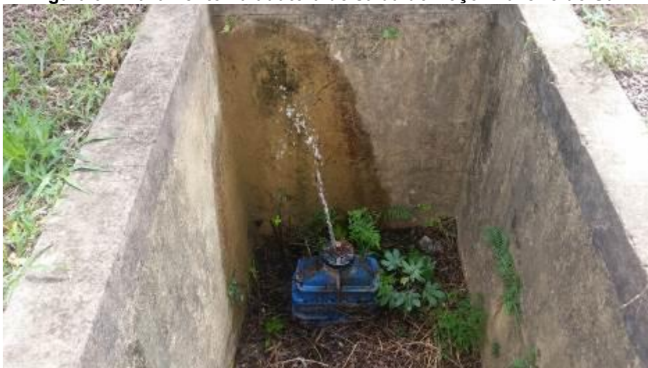
Figura 92: Vazamento na adutora de saída do Poço Cruzeiro do Sul.
