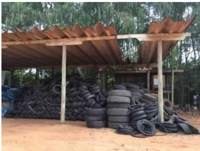
Figura 444: Telhado Danificado na Estrutura
