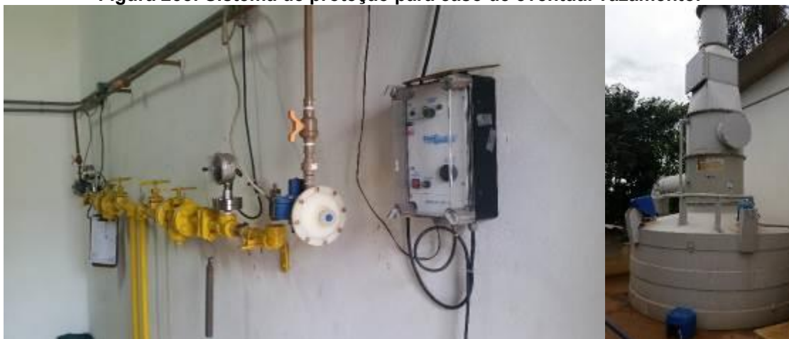
Figura 258: Sistema de proteção para caso de eventual vazamento.
