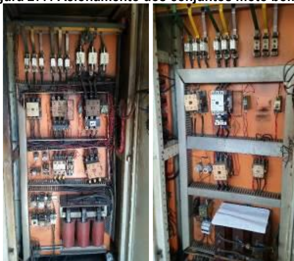
Figura 277: Acionamento dos conjuntos moto bomba.
