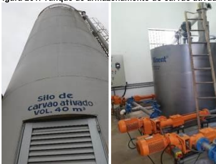
Figura 261: Tanque de armazenamento do carvão ativado.
