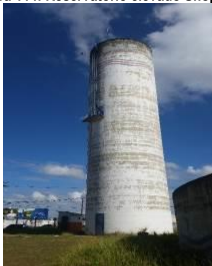
Figura 114: Reservatório elevado Shopping.
