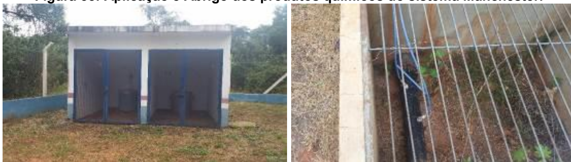
Figura 55: Aplicação e Abrigo dos produtos químicos do sistema Manchester.
