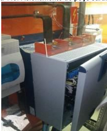
Figura 119: Acionamento do poço Jardim TV.
