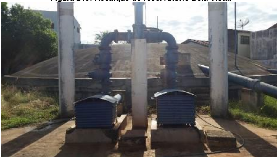
Figura 213: Recalque do reservatório Bela Vista.
