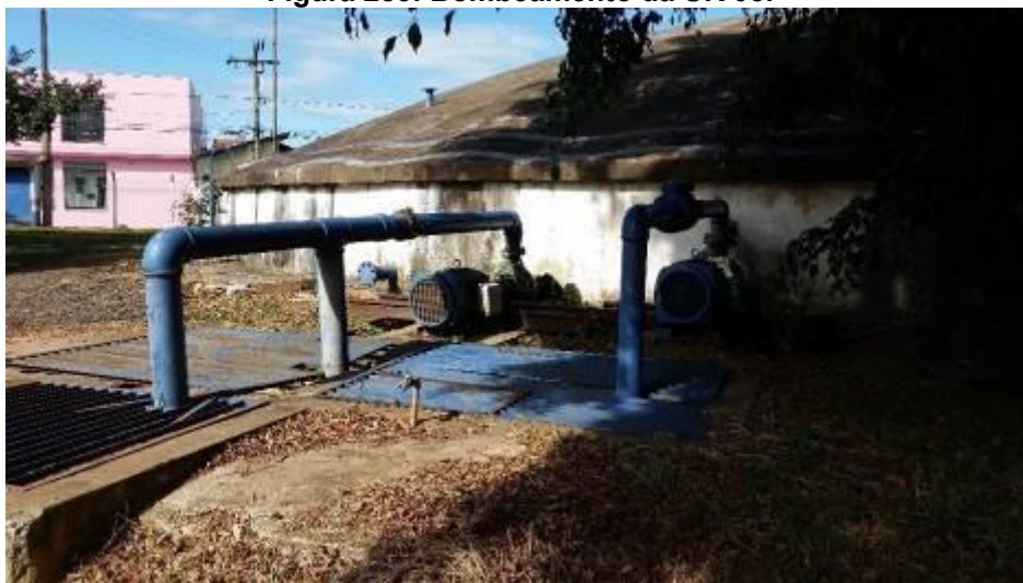
Figura 283: Bombeamento da UR 05.
