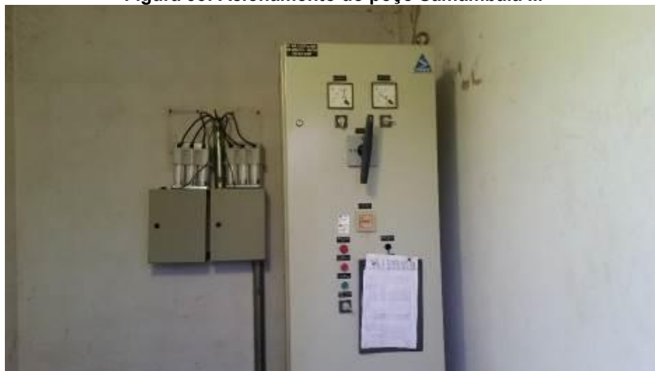
Figura 33: Acionamento do poço Samambaia II.
