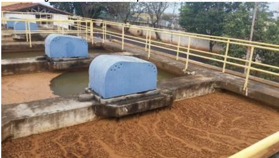
Figura 243: Excesso de espuma formada no flocculador.
