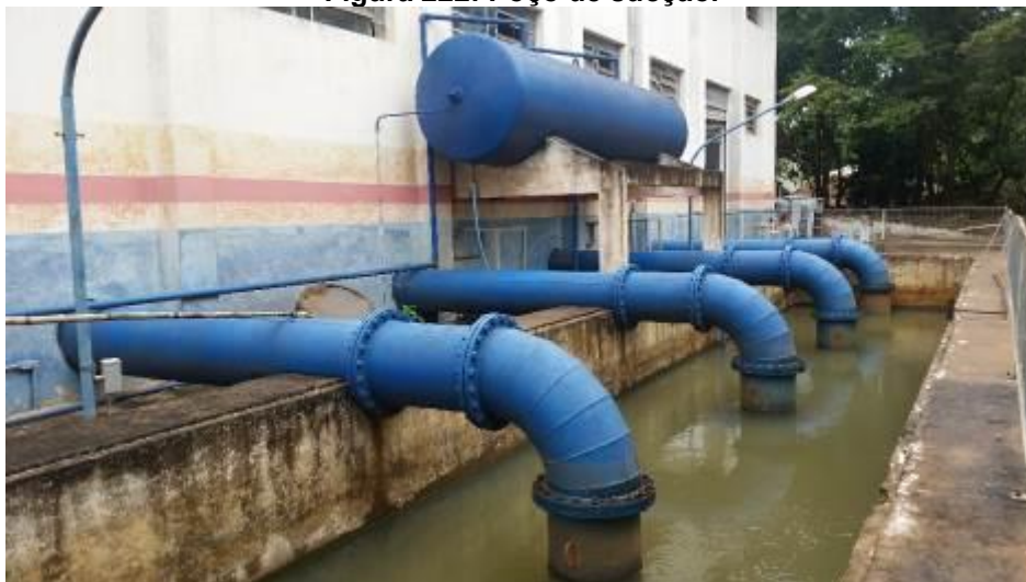
Figura 222: Poço de sucção.
