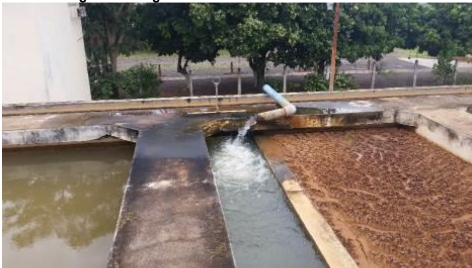
Figura 250: Água de retorno do vazamento dos filtros.
