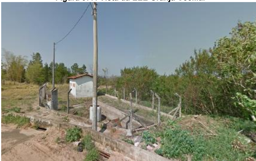
Figura 377: Vista da EEE Granja Cecília.
