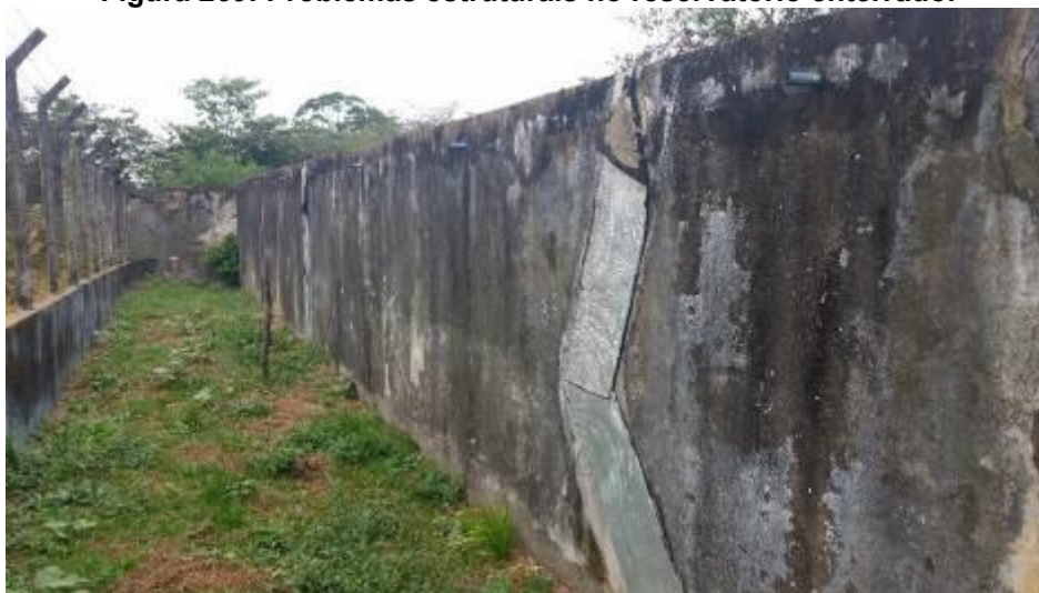
Figura 269: Problemas estruturais no reservatório enterrado.
