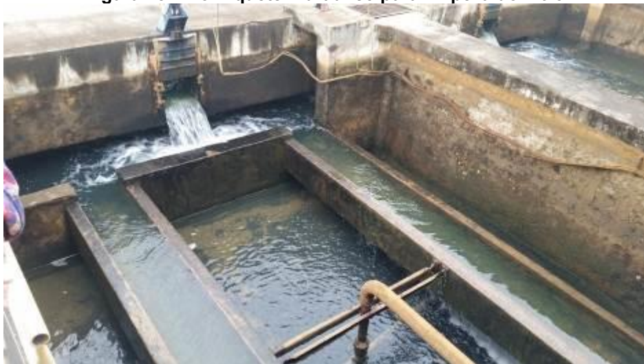
Figura 252: Torniquete hidráulico para limpeza do filtro.
