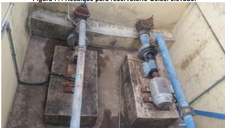
Figura 77: Recalque para reservatório Geisel elevado.
