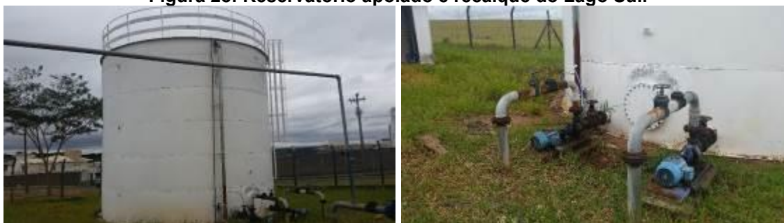
Figura 28: Reservatório apoiado e recalque do Lago Sul.
