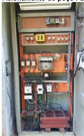
Figura 152: Acionamento do poço Parque Real II.
