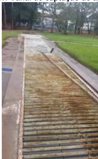
Figura 221: Canal de captação de água bruta.
