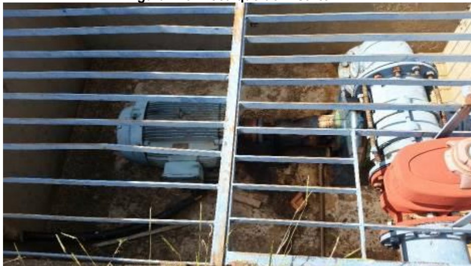
Figura 173: Recalque do Distrito III.
