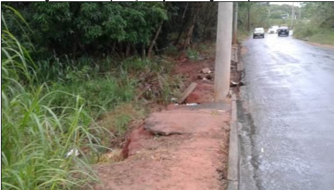
Figura 545 – Exemplificação sarjetas ao longo da via pavimentada.
