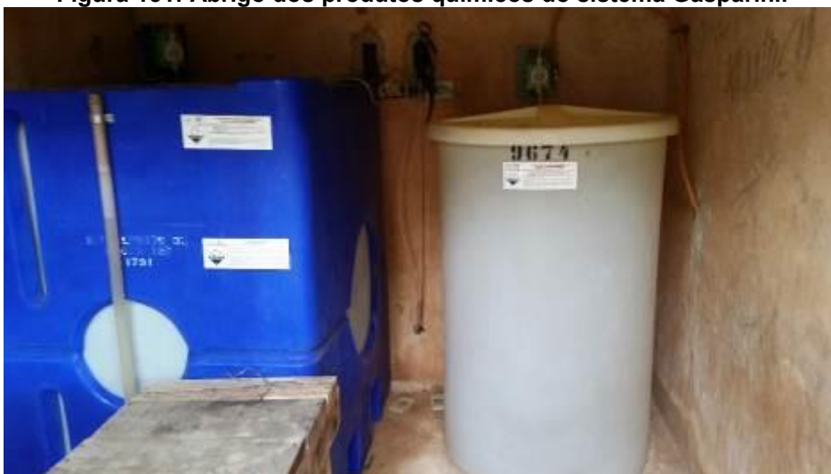
Figura 131: Abrigo dos produtos químicos do sistema Gasparini.
