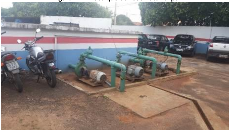
Figura 122: Recalque do reservatório Ipê.
