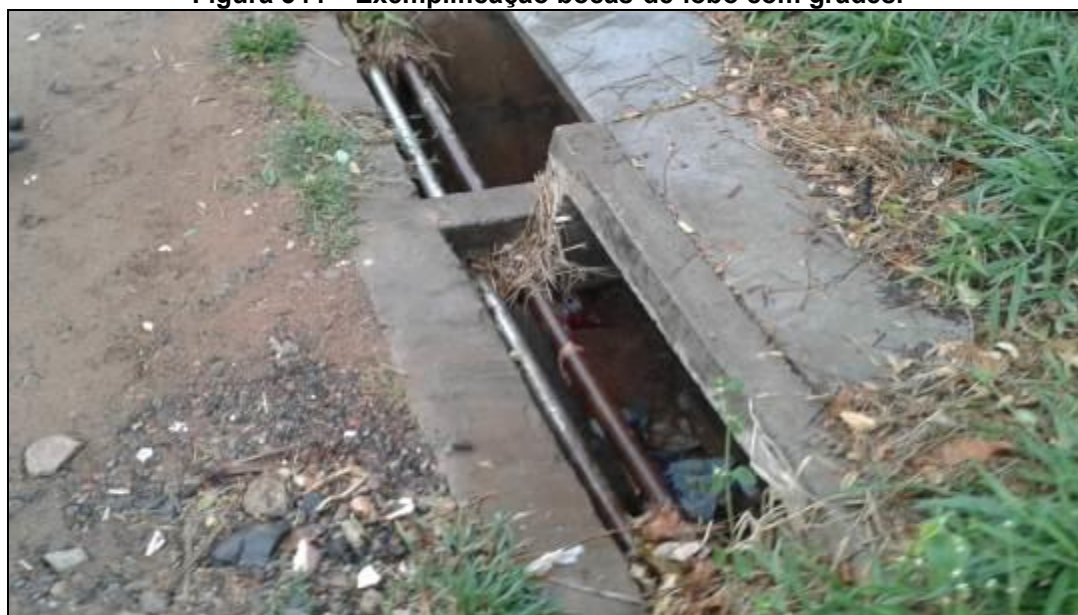
Figura 544 – Exemplificação bocas-de-lobo com grades.
