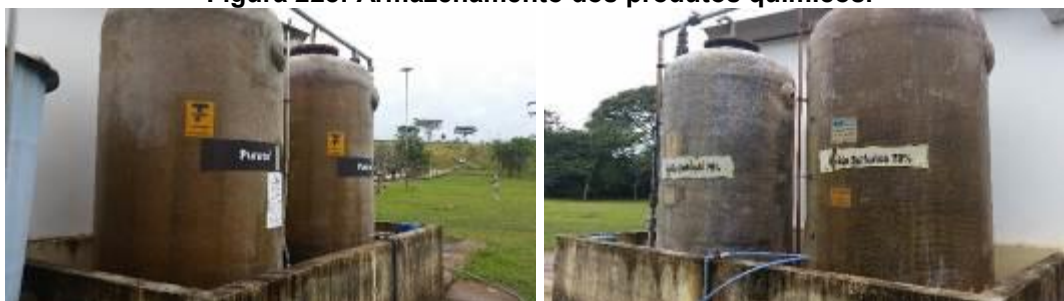
Figura 228: Armazenamento dos produtos químicos.
