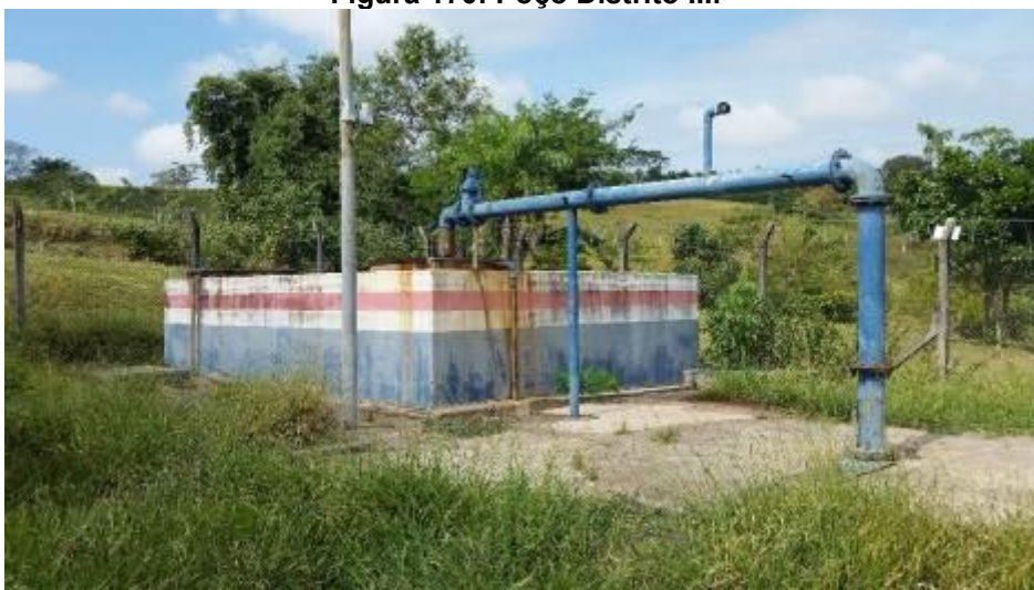
Figura 170: Poço Distrito III.
