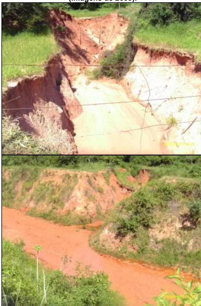
Figura 563 – Voçorocamento no Distrito de Tibiriçá, jusante do lançamento da drenagem local. (Imagens de 2009).
