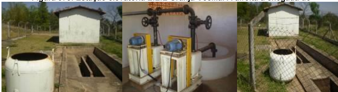
Figura 378: Estação elevatória E.E.E Granja Cecília. À direita a chegada do
