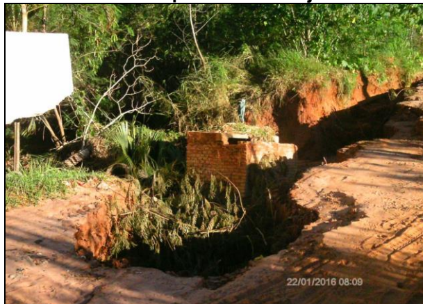
Figura 572 – Danos causados pela Chuva em janeiro – Rua Luiz Berro.
