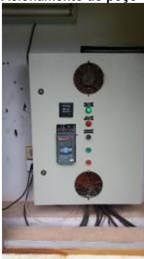
Figura 19: Acionamento do poço Villaggio III.
