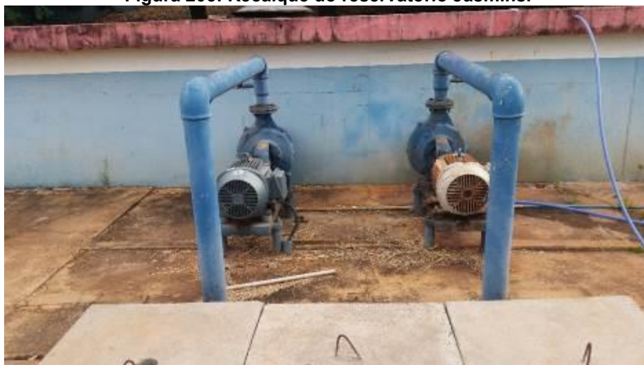
Figura 205: Recalque do reservatório Jasmins.
