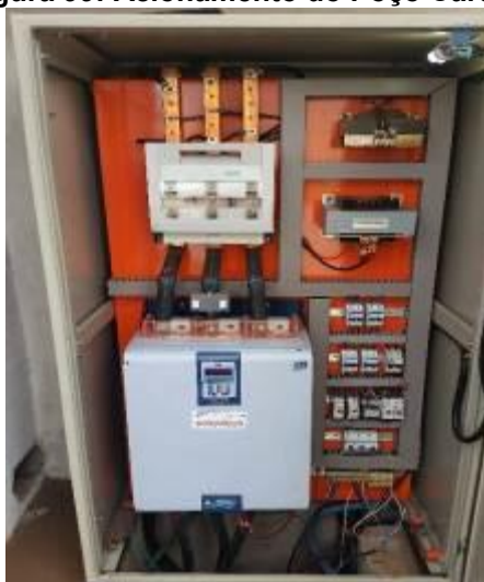
Figura 99: Acionamento do Poço Cardia.
