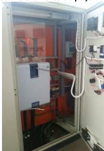
Figura 138: Acionamento do poço Zona Norte.
