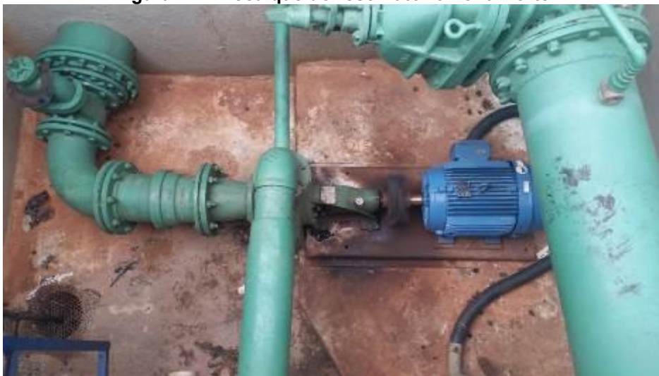
Figura 141: Recalque do reservatório Zona Norte.
