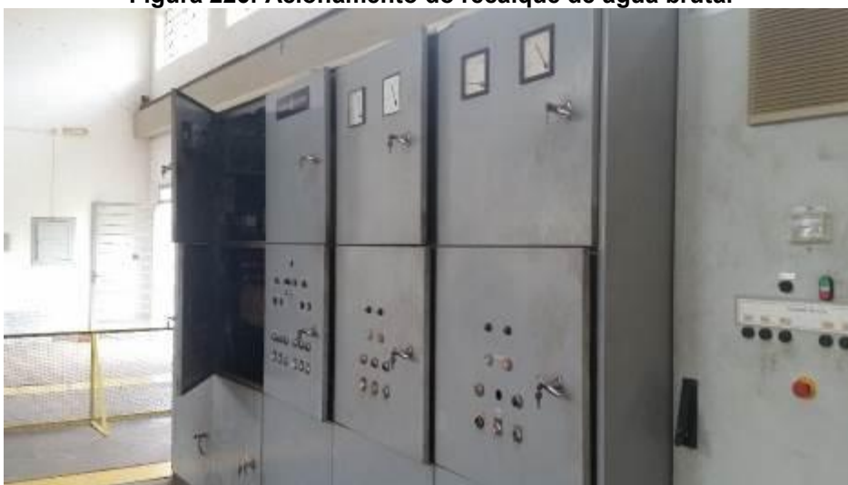
Figura 226: Acionamento do recalque de água bruta.
