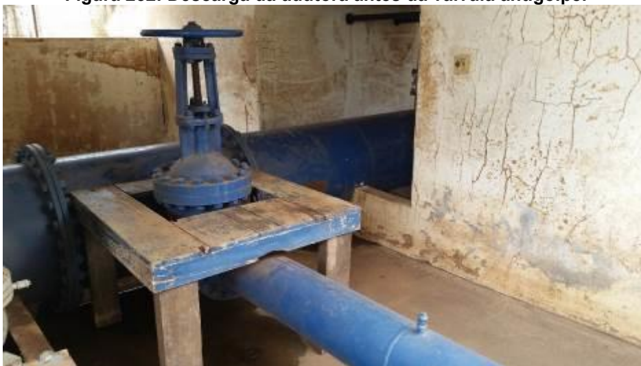
Figura 232: Descarga da adutora antes da válvula antigolpe.
