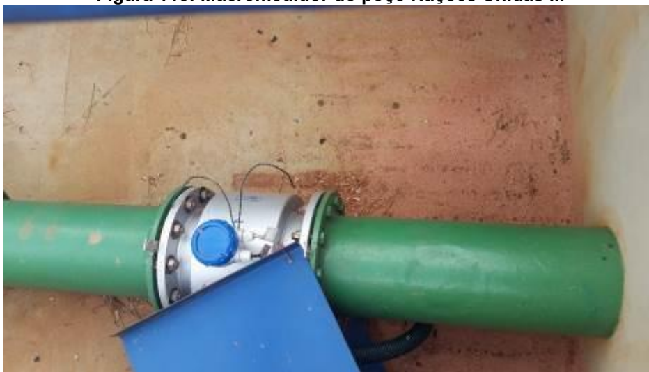
Figura 118: Macromedidor do poço Nações Unidas II.
