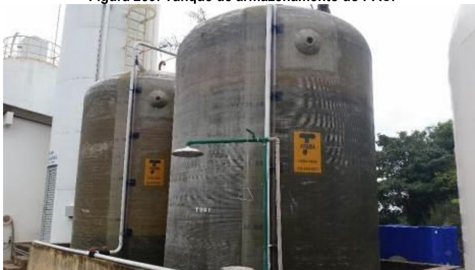
Figura 259: Tanque de armazenamento do PAC.
