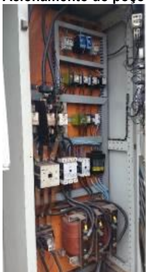
Figura 69: Acionamento do poço Bauru XXV.
