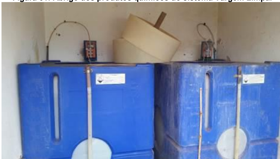
Figura 61: Abrigo dos produtos químicos do sistema Vargem Limpa.
