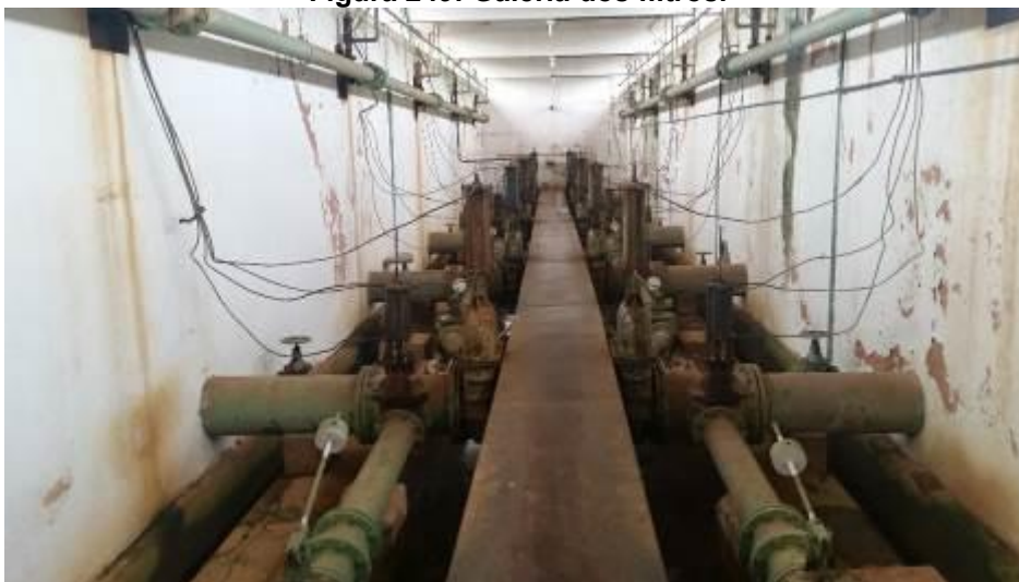
Figura 249: Galeria dos filtros.
