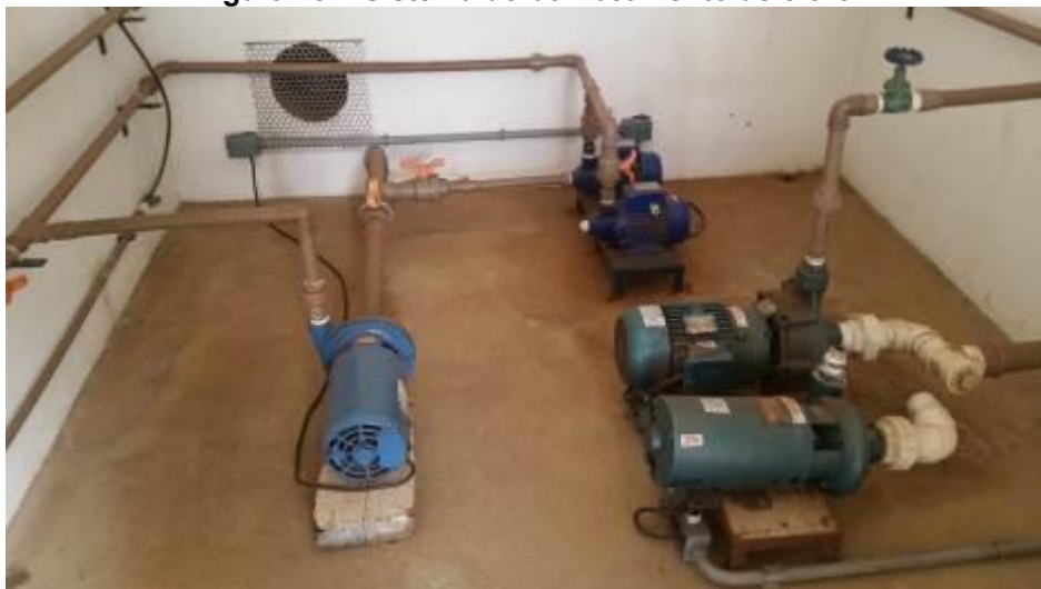
Figura 257: Sistema de bombeamento de cloro.
