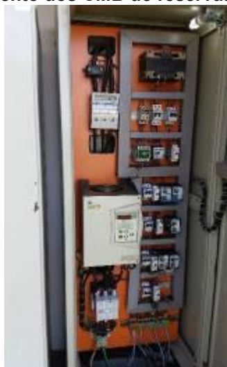
Figura 163: Acionamento dos CMB do reservatório Nova Esperança.
