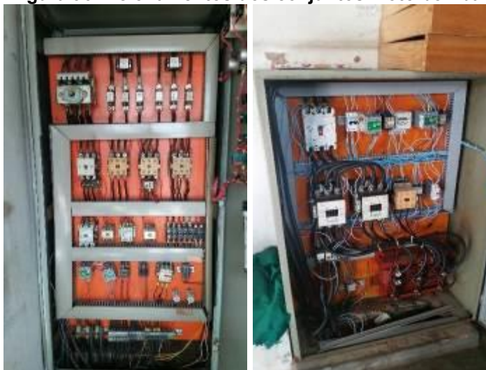
Figura 96: Acionamentos dos conjuntos moto bomba.
