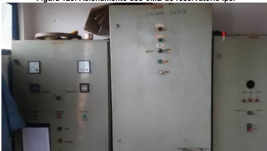
Figura 123: Acionamento dos CMB do reservatório Ipê.
