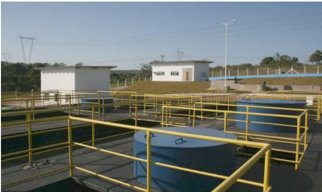
Figura 408: Reator anaeróbio + casa do operador.
