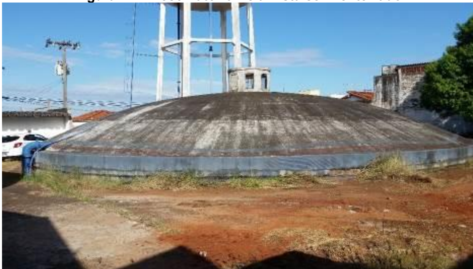
Figura 211: Reservatório Bela Vista semi enterrado.
