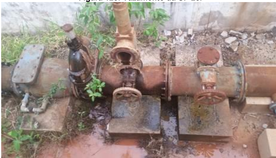
Figura 128: Vazamento da UP 25.
