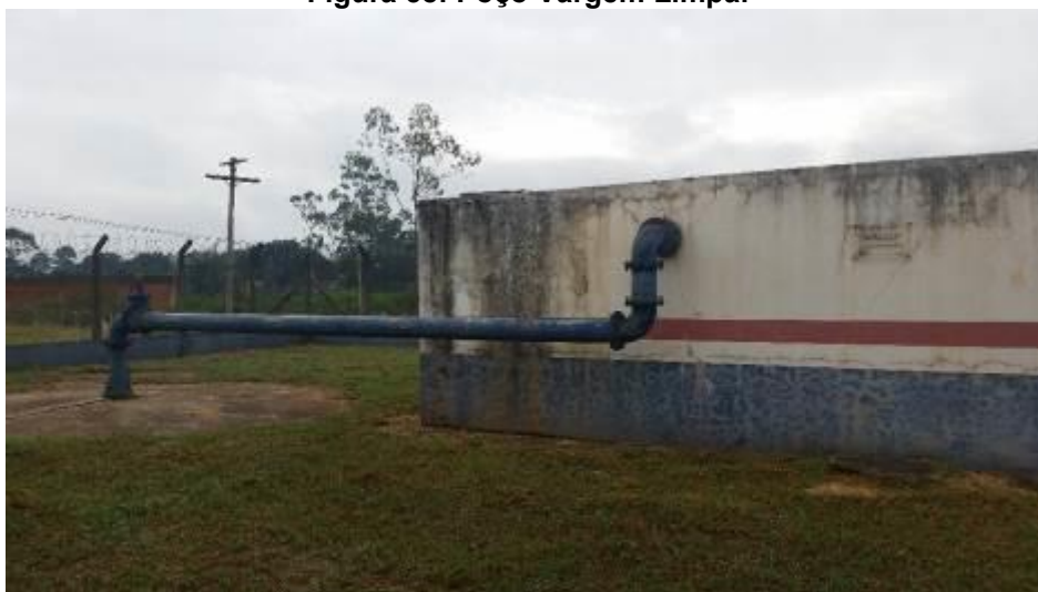
Figura 58: Poço Vargem Limpa.
