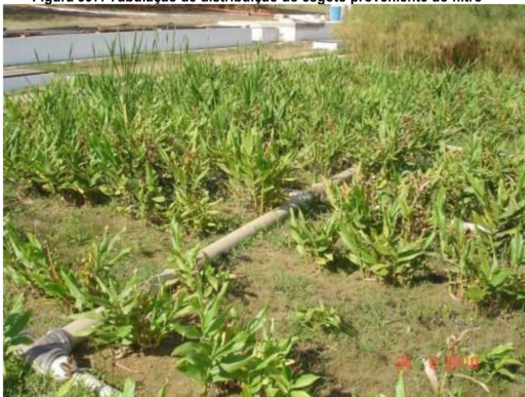
Figura 397: Tubulação de distribuição do esgoto proveniente do filtro
