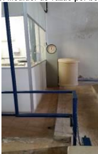
Figura 239: Medidor de vazão por boia de nível.
