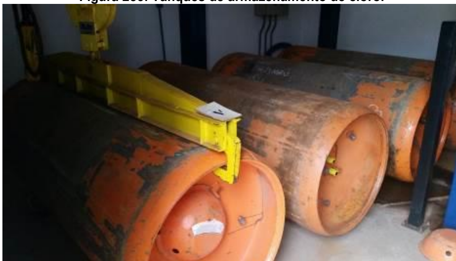
Figura 256: Tanques de armazenamento de cloro.
