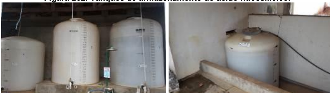
Figura 262: Tanques de armazenamento do ácido fluossilícico.
