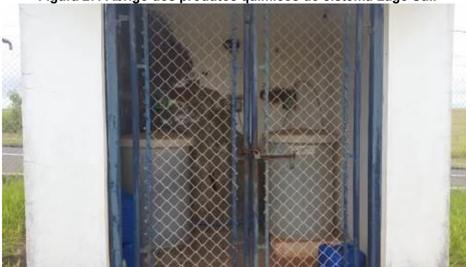
Figura 27: Abrigo dos produtos químicos do sistema Lago Sul.
