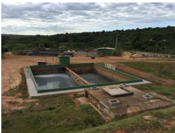
Figura 481: Tanque de Armazenamento de Chorume
