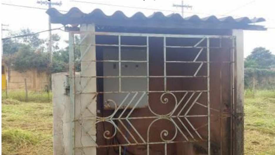
Figura 50: Acionamento do poço Chácara Bauruense.
