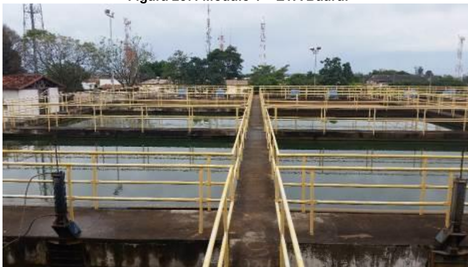
Figura 237: Módulo 1 – ETA Bauru.
