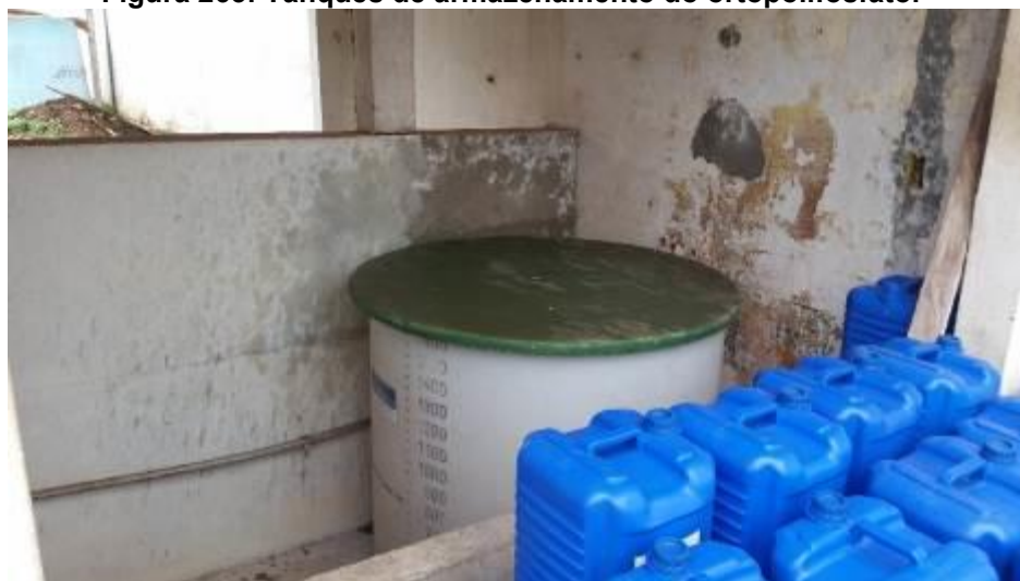
Figura 263: Tanques de armazenamento do ortopolifosfato.
