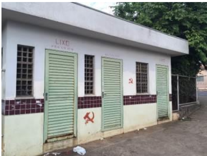
Figura 426: Acondicionamento Externo dos RSS – Pronto Socorro Central
