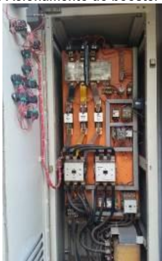
Figura 295: Acionamento do booster Vila Falcão.
