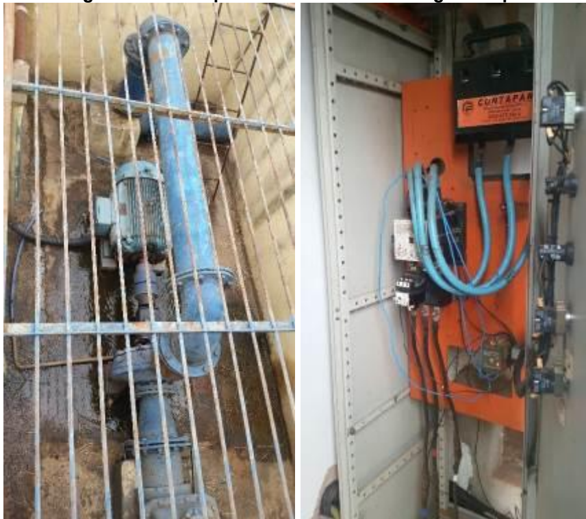
Figura 62: Recalque e acionamento da Vargem limpa.
