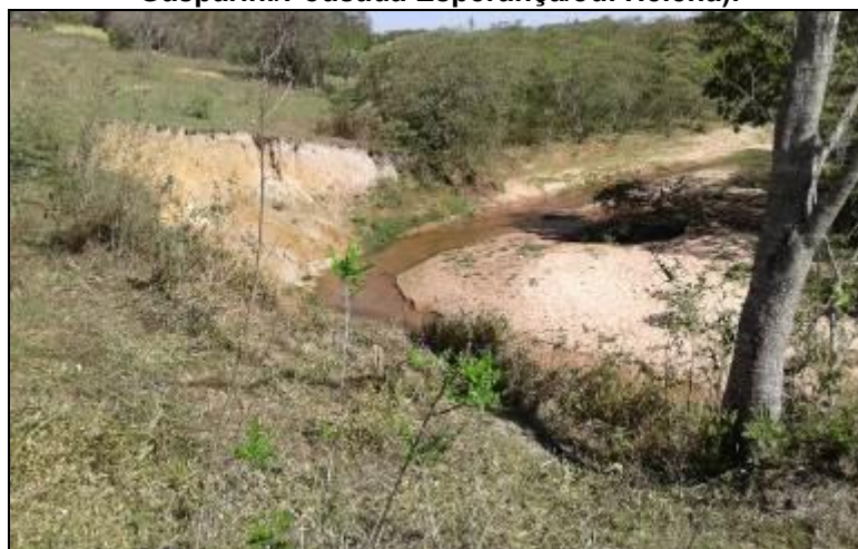
Figura 567 – Aspecto dos processos erosivos Córrego Água Parada (proximidades do N. Gasparini/Pousada Esperança/Jd. Helena).
