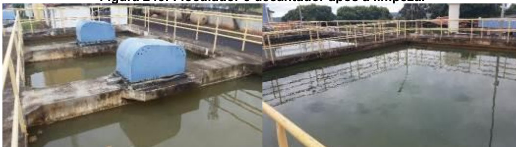
Figura 245: Floculador e decantador após a limpeza.
