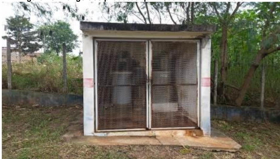
Figura 70: Abrigo dos produtos químicos do sistema Bauru XXV.
