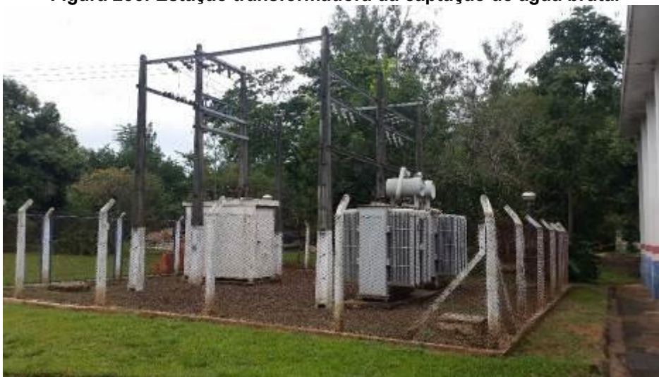
Figura 236: Estação transformadora da captação de água bruta.
