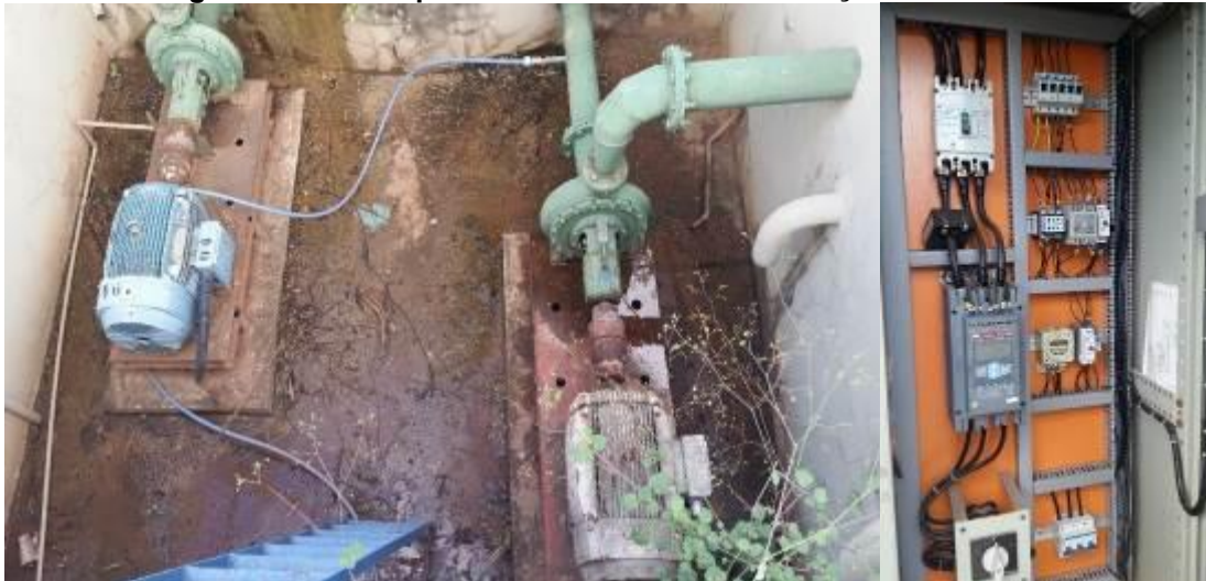
Figura 108: Recalque e acionamento do CMB Nações Unidas II.
