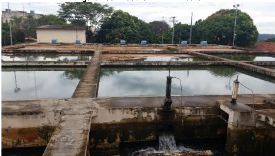
Figura 238: Módulo 2 – ETA Bauru.
