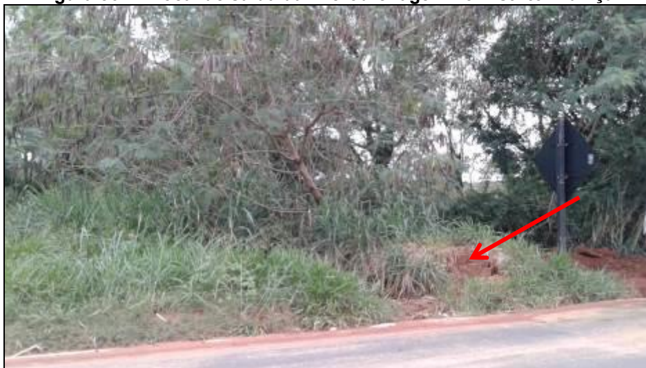
Figura 562 – Local de saída da microdrenagem no Distrito Tibiriçá.
