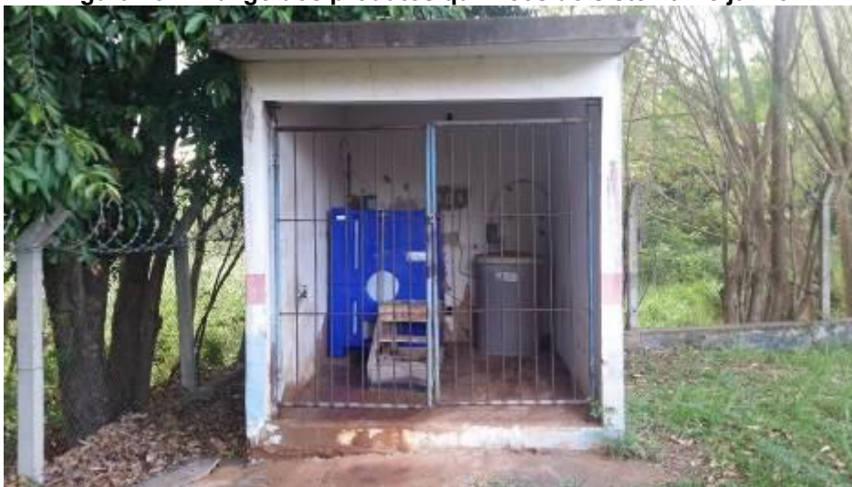
Figura 192: Abrigo dos produtos químicos do sistema Beija Flor.
