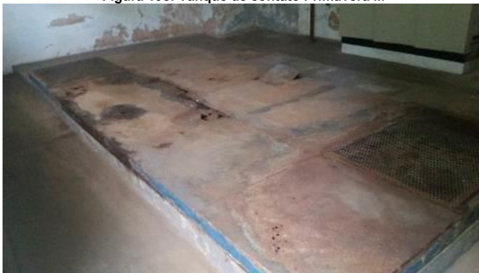
Figura 198: Tanque de contato Primavera II.
