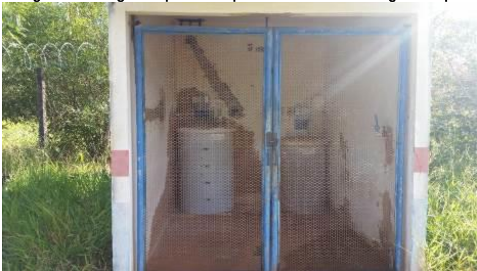
Figura 75: Abrigo dos produtos químicos do sistema Vargem Limpa.
