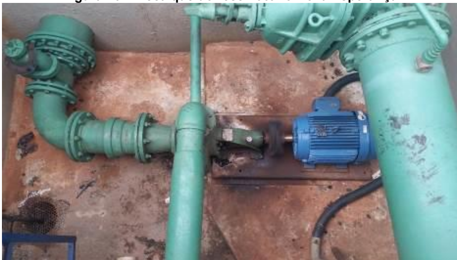
Figura 162: Recalque do reservatório Nova Esperança.
