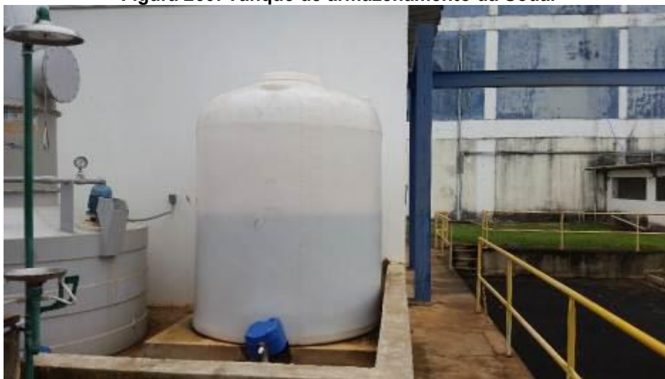
Figura 260: Tanque de armazenamento da Soda.
