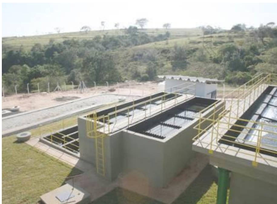
Figura 405: Tanque de contato
