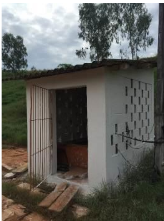
Figura 485: Poço de Recalque de Chorume
