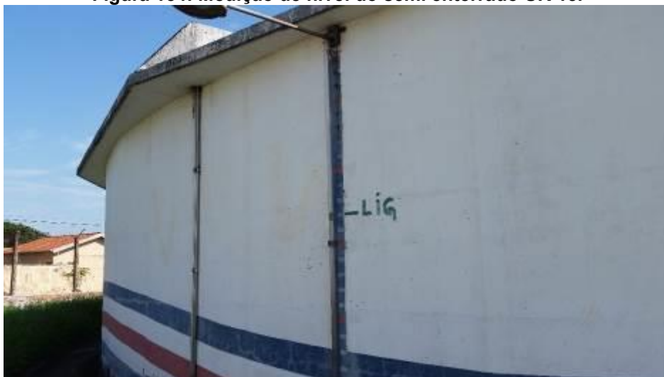
Figura 154: Medição de nível do semi enterrado UR 15.
