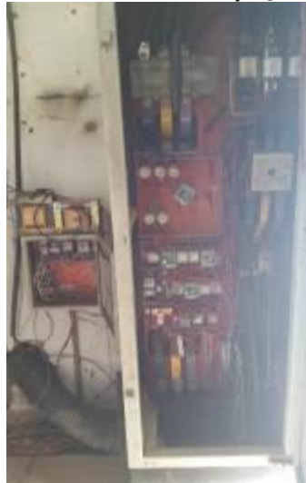
Figura 171: Acionamento do poço Distrito III.
