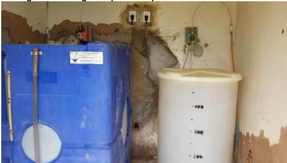
Figura 172: Abrigo dos produtos químicos do sistema Distrito III.
