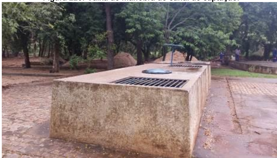
Figura 223: Caixa de manobra do canal de captação.
