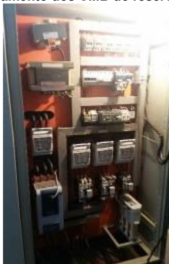
Figura 142: Acionamento dos CMB do reservatório Zona Norte.
