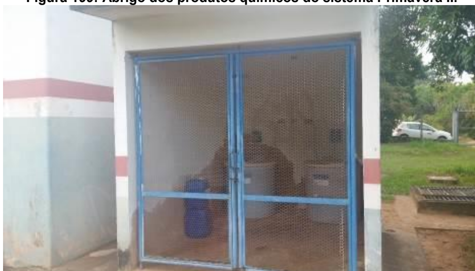
Figura 199: Abrigo dos produtos químicos do sistema Primavera II.
