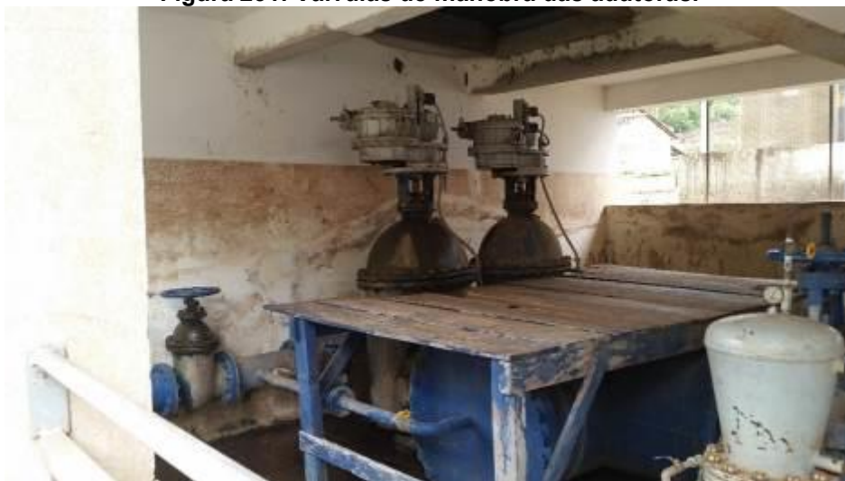
Figura 231: Válvulas de manobra das adutoras.
