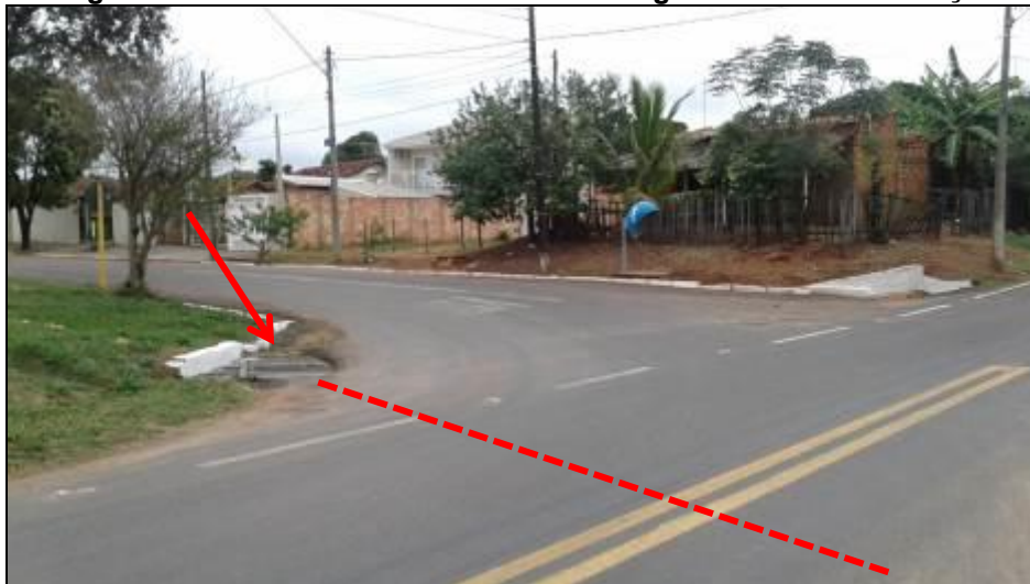
Figura 561 – Local de saída da microdrenagem no Distrito Tibiriçá.
