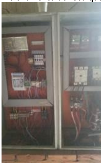
Figura 188: Acionamento do recalque Mary Dota.
