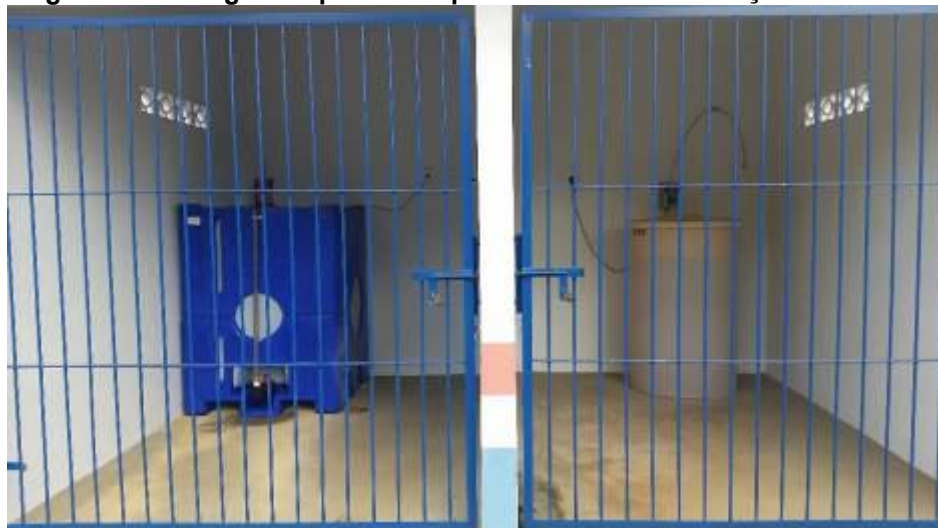
Figura 107: Abrigo dos produtos químicos do sistema Nações Unidas II.
