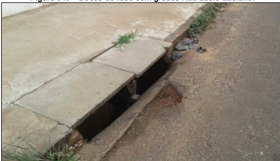
Figura 549 – Bocas-de-lobo sem grades Rua Lucio Luciano.
