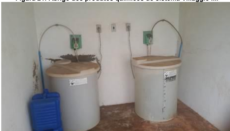
Figura 21: Abrigo dos produtos químicos do sistema Villaggio III.
