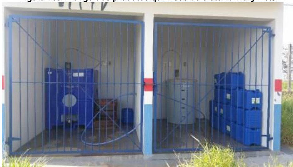
Figura 185: Abrigo dos produtos químicos do sistema Mary Dota.
