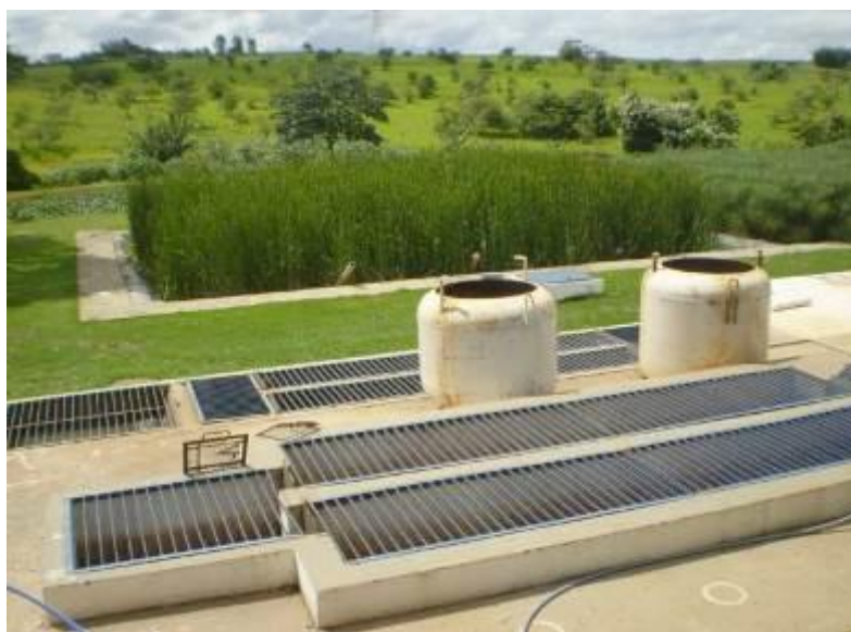
Figura 395: Em primeiro plano o gradeamento e caixa e caixa de areia. Ao fundo os alagados construídos.
