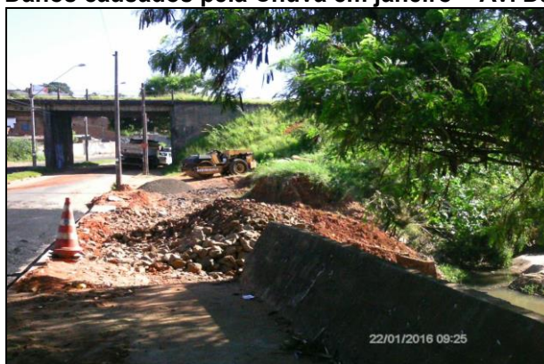
Figura 570 – Danos causados pela Chuva em janeiro – Av. Daniel Pacífico.
