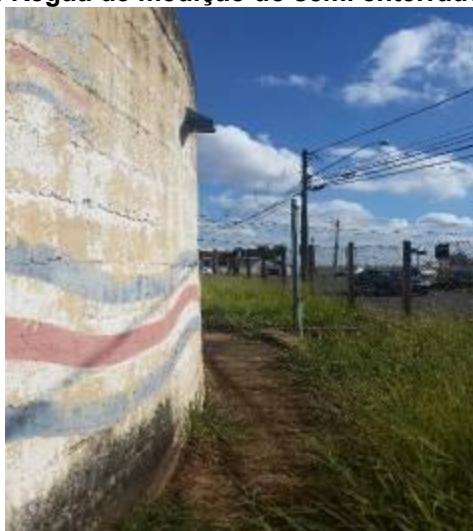
Figura 110: Régua de medição do semi enterrado Shopping.
