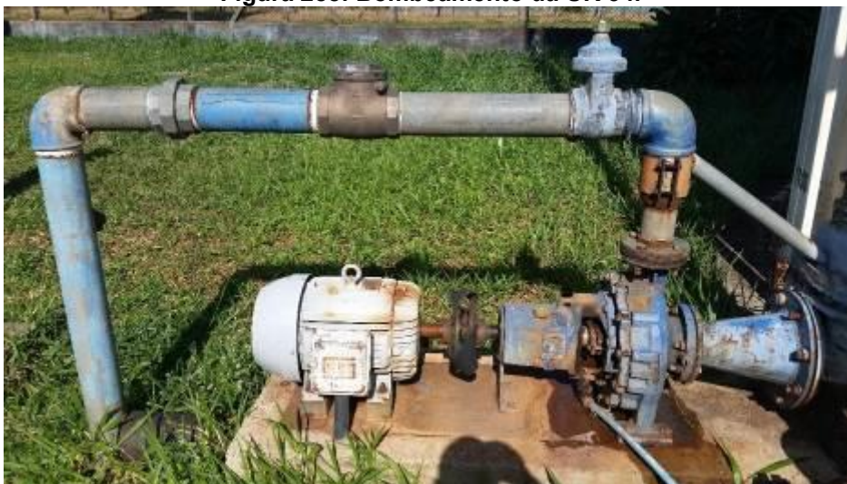
Figura 288: Bombeamento da UR 34.
