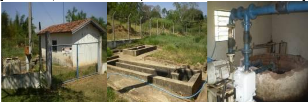
Figura 375: Estação elevatória E.E.E Parque Santa Cândida/Leão XIII. Ao centro a chegada
