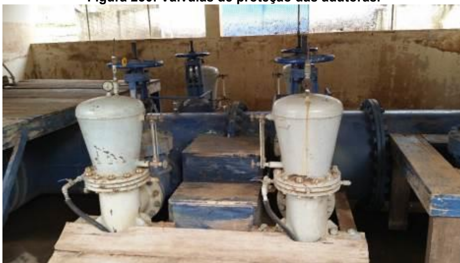
Figura 230: Válvulas de proteção das adutoras.
