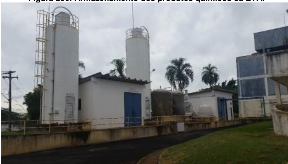
Figura 255: Armazenamento dos produtos químicos da ETA.
