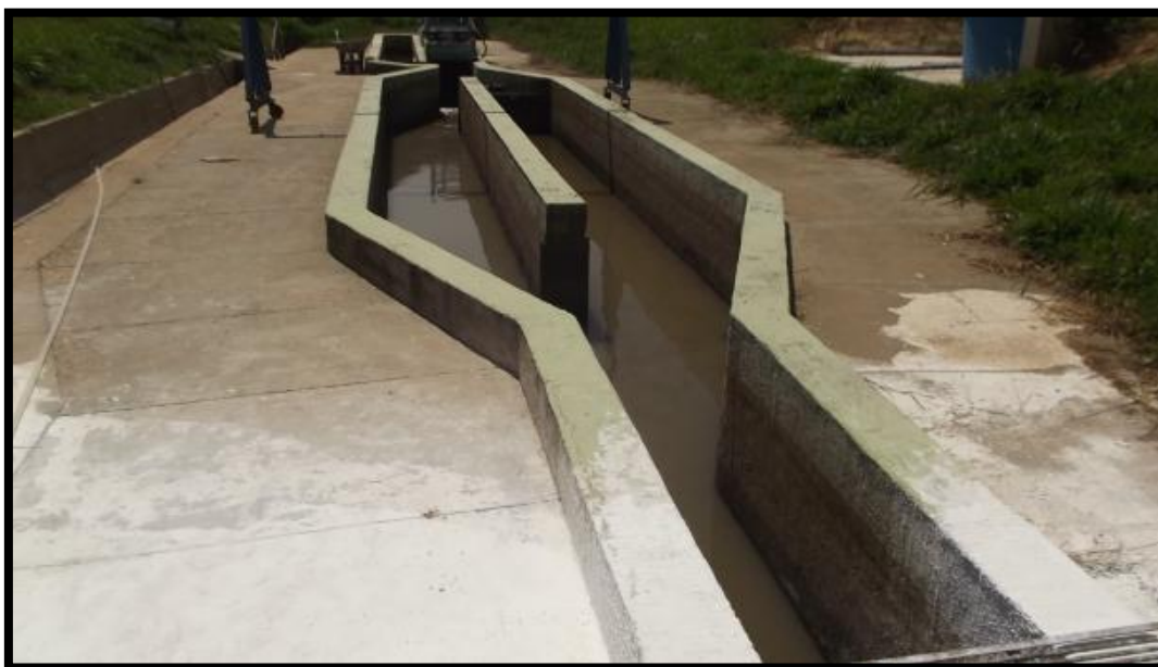
Figura 24 - Tratamentos Preliminares na ETE
