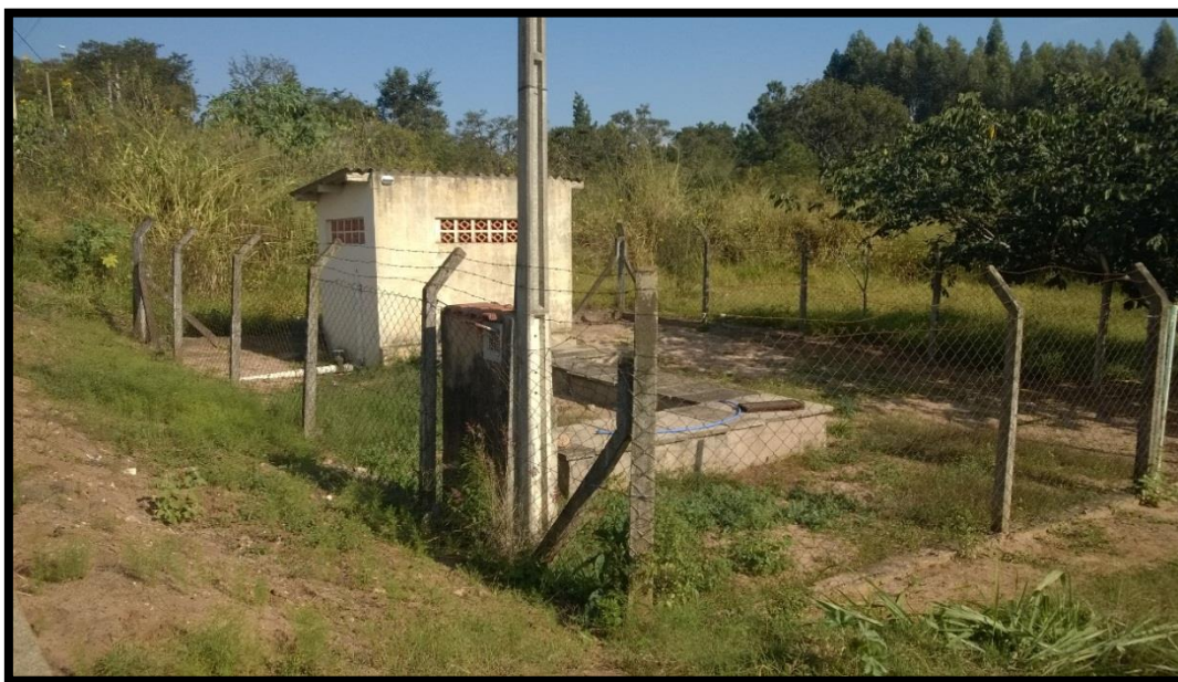
Figura 30 - Estação Elevatória de Esgoto 01 - Jardim Lemos
