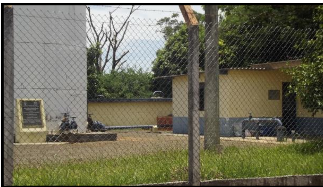
Figura 11 - Reservatório 1 e Poço 01– Rua 5- Vila Garbi
