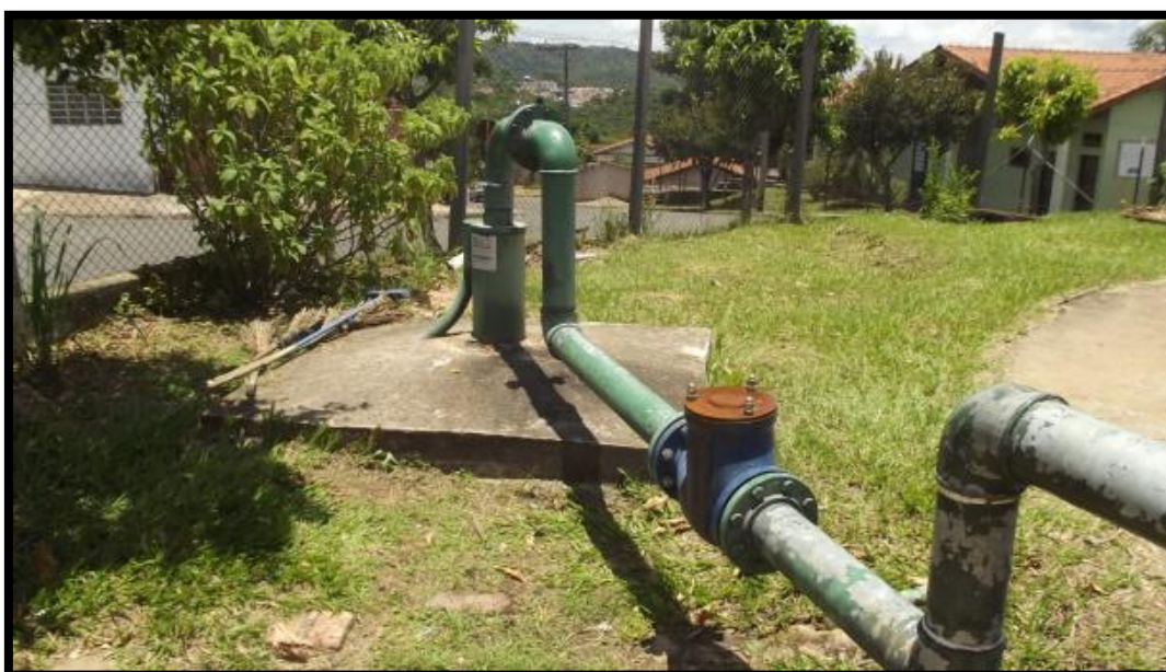
Figura 5 - Poço 9, Reservatório 3 – Enterrado, Rua Cataguazes
