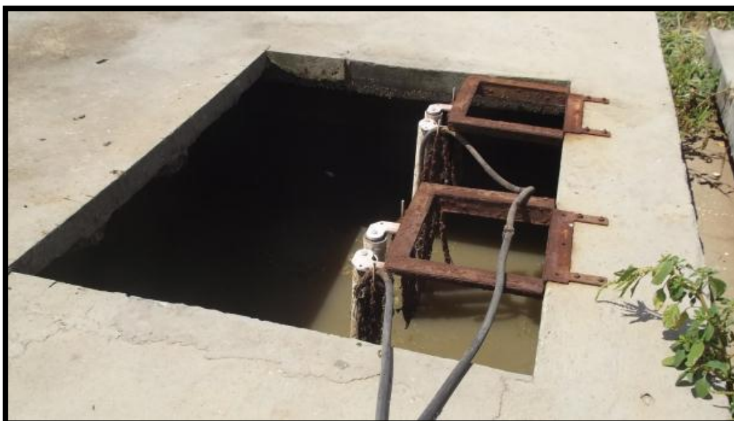
Figura 29 - Estação Elevatória da ETE
