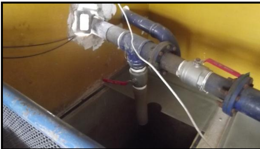
Figura 6 - Decantador do Poço 09, Reservatório 03
