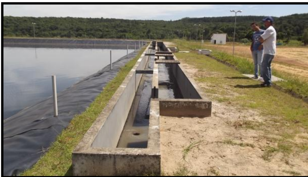
Figura 28 - Canaleta de distribuição da Lagoa Anaeróbia
